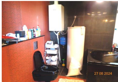
Gāzes apkures katls un elektriskais boilers vannas istabā
