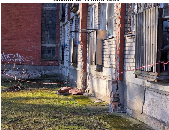
Daudzdzīvokļu ēkas fasādes bojājumi
