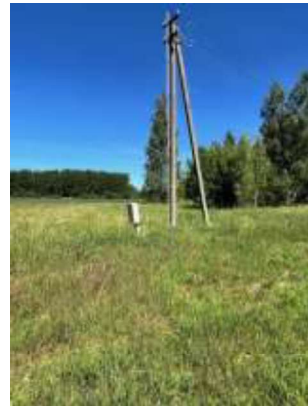
Elektrības pieslēguma vieta
