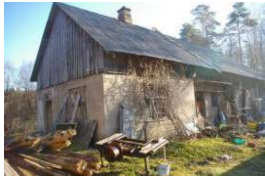
Savstarpēji bloķētas Būve (saimniecības ēka) ar kadastra apzīmējumu 6484 008 0322 003, Būve (kūts ēka) ar kadastra apzīmējumu 6484 008 0322 004, Būve (šķūņa ēka) ar kadastra apzīmējumu 6484 008 0322 006
