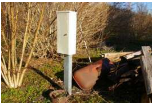
1.zemes vienība ar kadastra apzīmējumu 6484 008 0322, elektrosadalne un uzskate
