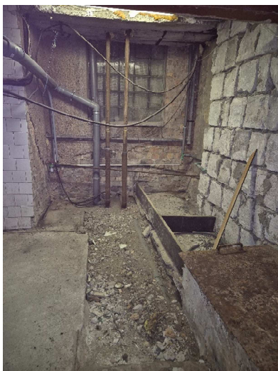
Kanalizācijas notekūdeņu kolektora telpa
