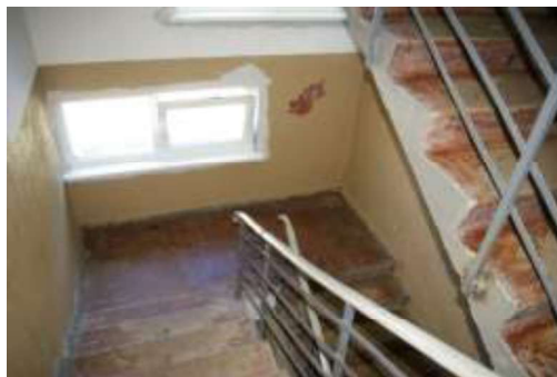
Būve ar kadastra apzīmējumu 6409 003 0086 001 , koplietošanas telpa
