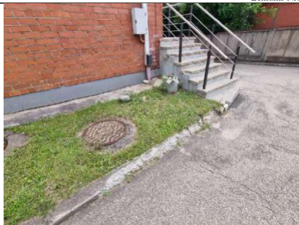
3.1.2. att. Asfaltbetona segums, lokāli apmaļu bojājumi
