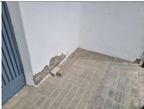
4.19.5. att. Ārējās apdares bojājumi
