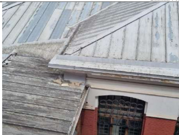
4.8.2.2. att. Vēsturiskās daļas jumta seguma bojāts seguma krāsojums
