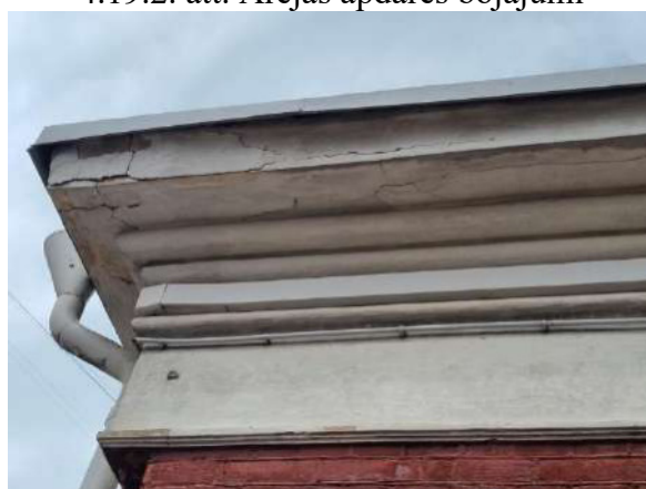
4.19.4. att. Ārējās apdares bojājumi
