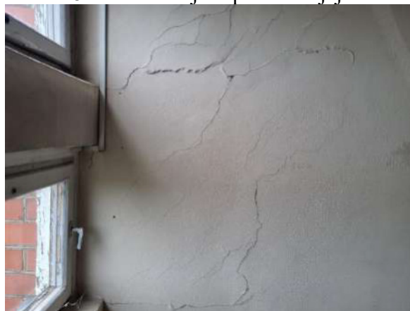
4.18.4. att. Iekšējās apdares bojājumi
