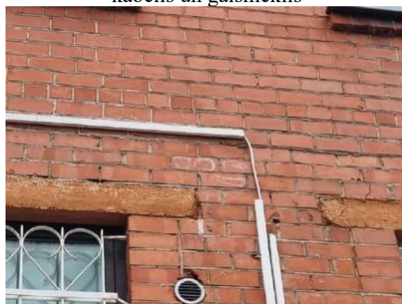
5.9.4. att. Bojāta aizsargcaurule, neatbilstošs kabelis bez aizsardzības
