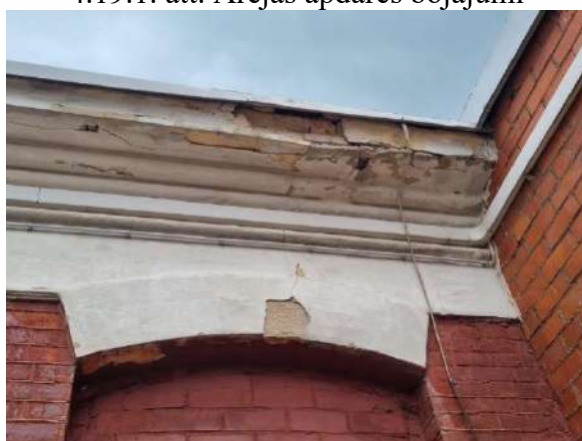
4.19.3. att. Ārējās apdares bojājumi
