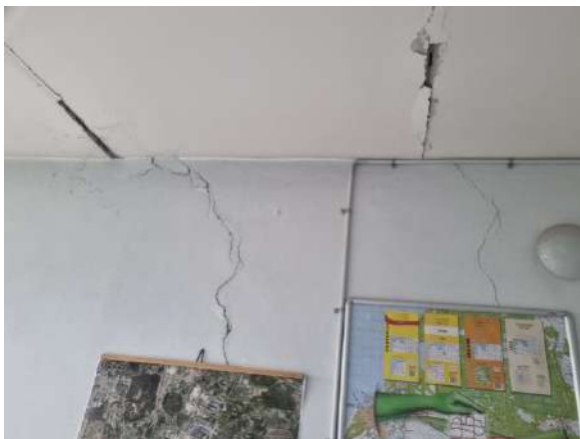
4.6.2.1. att. Saliekamā dzelzsbetona plātnes, javas izdrupumi no paneļu šuvēm
