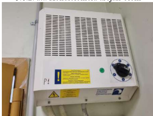
5.6.4. att. Mehāniskā ventilācija
