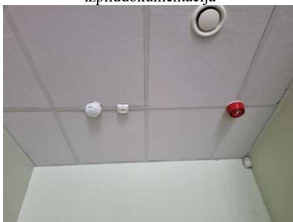
5.11.9. att. Ugunsgrēka atklāšanas un trauksmes signalizācijas sistēmas detektors un virsgriestu detektora indikators
