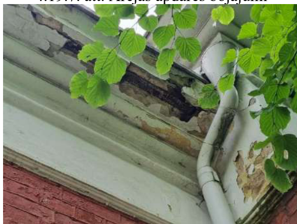
4.19.9. att. Ārējās apdares bojājumi
