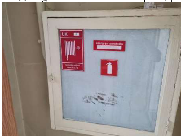
5.3.1. att. Ugunsdzēsības ūdensvada krānu skapis
