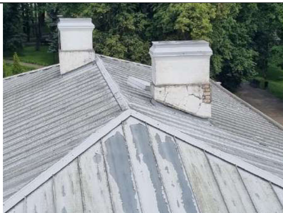
4.16.7. att. Dabiskās ventilācijas kanālu izvadu apdares bojājumi
