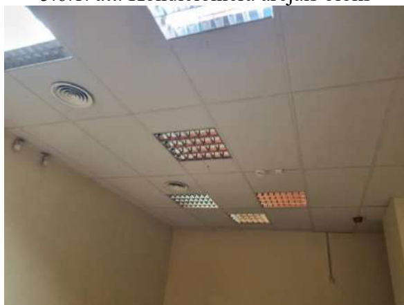
5.6.3. att. Mehāniskā ventilācija
