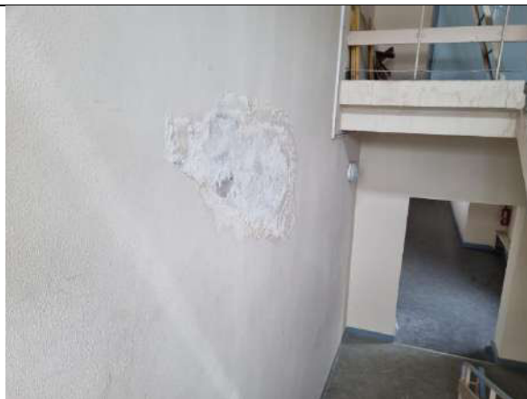
4.18.5. att. Iekšējās apdares bojājumi
