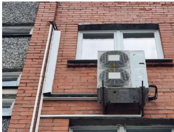
5.6.2. att. Kondicioniera ārējais bloks
