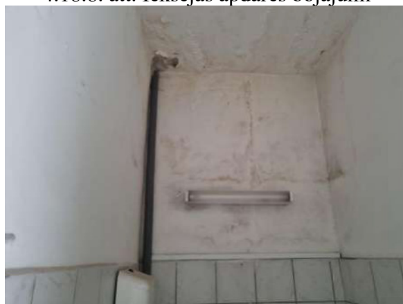
4.18.10. att. Iekšējās apdares bojājumi
