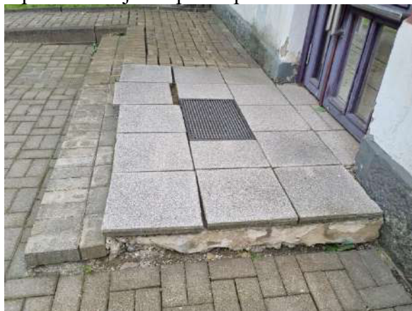
4.10.1. att. Ārējās kāpnes, betona struktūras bojājumi, segums zaudējis saķeri ar pamatni un izbūves stāvokli
