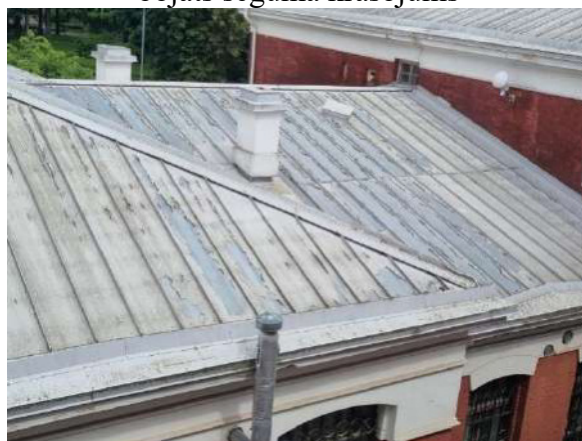
4.8.2.4. att. Vēsturiskās daļas jumta seguma bojāts seguma krāsojums
