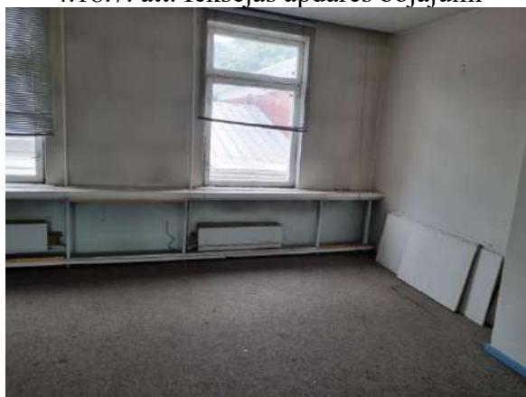
4.18.9. att. Iekšējās apdares bojājumi
