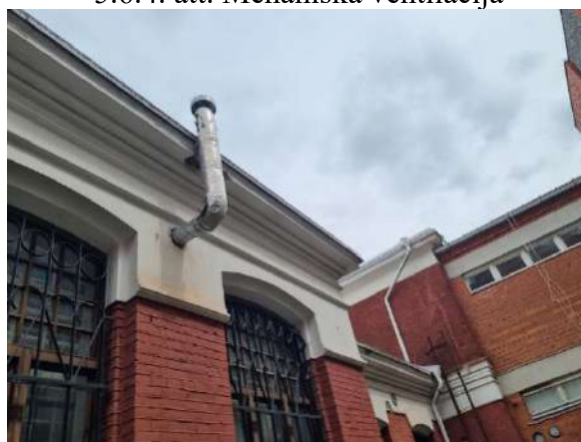
5.6.6. att. Mehāniskā ventilācija
