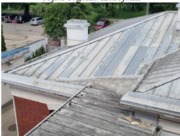
4.8.2.3. att. Vēsturiskās daļas jumta seguma bojāts seguma krāsojums
