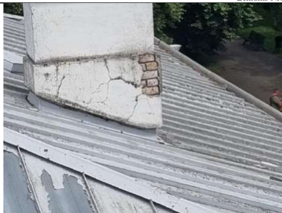
4.16.8. att. Dabiskās ventilācijas kanālu izvadu apdares bojājumi
