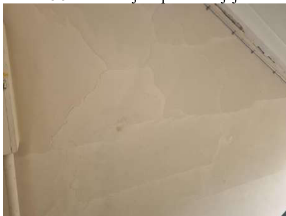
4.18.7. att. Iekšējās apdares bojājumi
