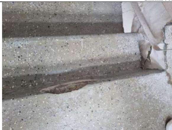
4.18.6. att. Iekšējās apdares bojājumi
