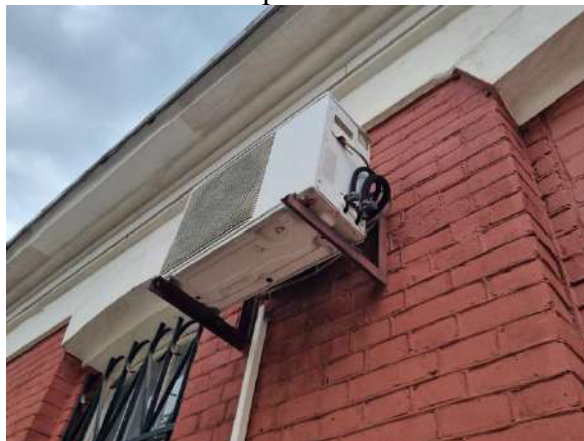
5.6.1. att. Kondicioniera ārējais bloks
