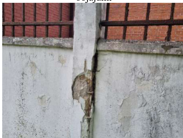
3.4.6. att. Teritorijas nožogojums, betona izdrupumi, virspusēja stiegrojuma korozija, apdares bojājumi
