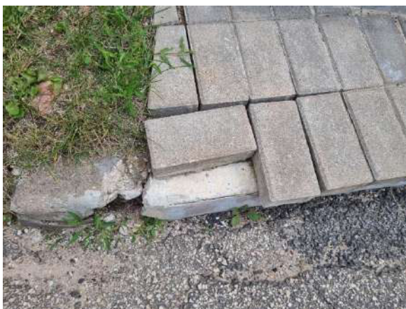
4.10.5. att. Ārējās kāpnes, segums zaudējis saķeri ar pamatni un izbūves stāvokli
