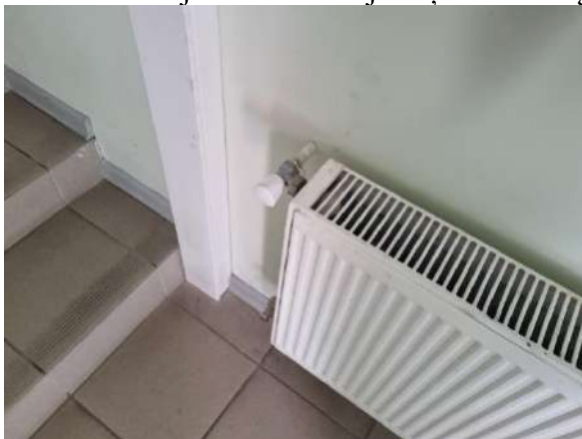
5.5.1. att. Radiators vēsturiskajā daļā
