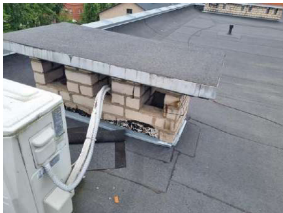
4.16.3. att. Dabiskās ventilācijas kanālā izbūvētas dzesēšanas iekārtas caurules
