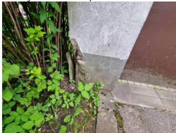
3.4.2. att. Teritorijas nožogojums, betona izdrupumi, virspusēja stiegrojuma korozija, apdares bojājumi
