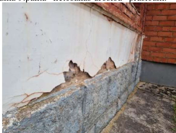
4.19.2. att. Ārējās apdares bojājumi
