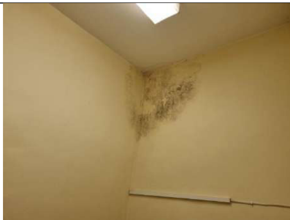
4.18.13. att. Iekšējās apdares bojājumi
