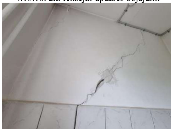
4.18.12. att. Iekšējās apdares bojājumi
