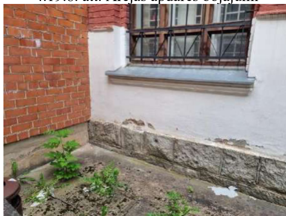
4.19.10. att. Ārējās apdares bojājumi
