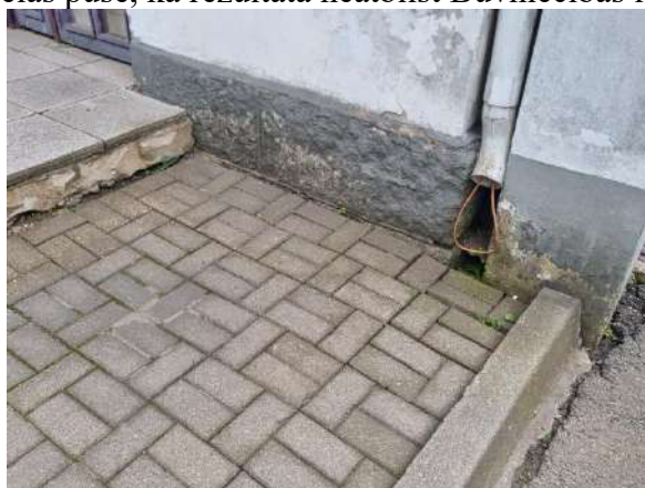
4.19.1. att. Ārējās apdares bojājumi
