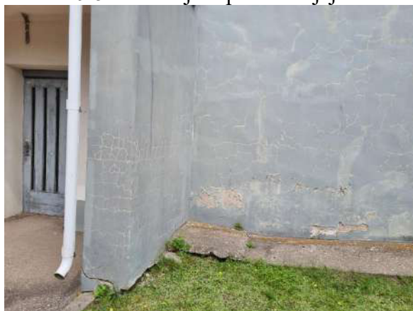
4.19.7. att. Ārējās apdares bojājumi
