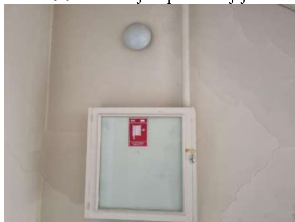
4.18.8. att. Iekšējās apdares bojājumi
