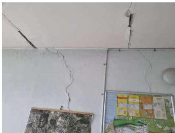
4.18.2. att. Iekšējās apdares bojājumi
