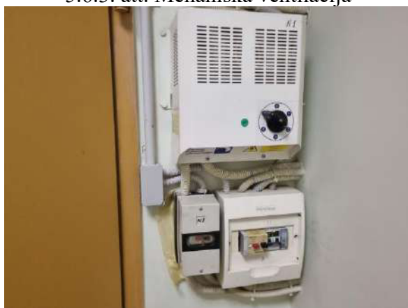
5.6.5. att. Mehāniskā ventilācija
