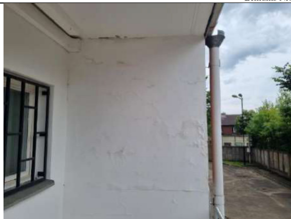
4.19.6. att. Ārējās apdares bojājumi
