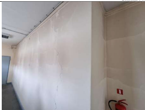
4.18.14. att. Iekšējās apdares bojājumi
