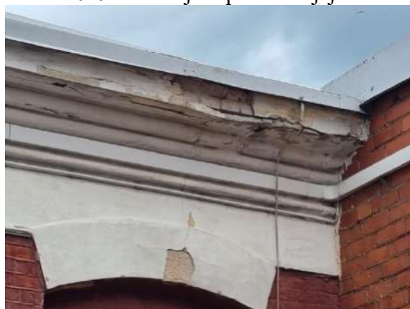
4.19.8. att. Ārējās apdares bojājumi
