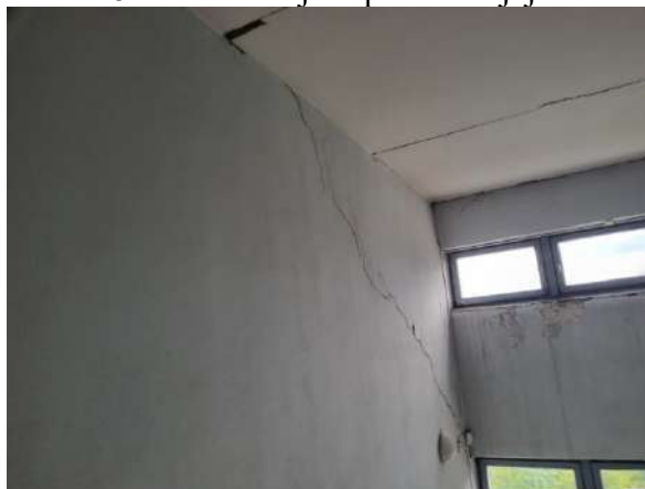
4.18.3. att. Iekšējās apdares bojājumi
