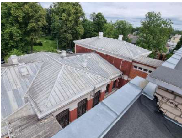
4.8.2.1. att. Vēsturiskās daļas jumta seguma bojāts seguma krāsojums
