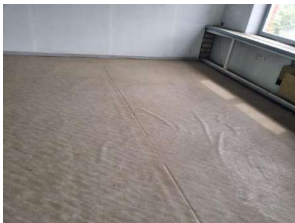
4.18.1. att. Iekšējās apdares bojājumi
