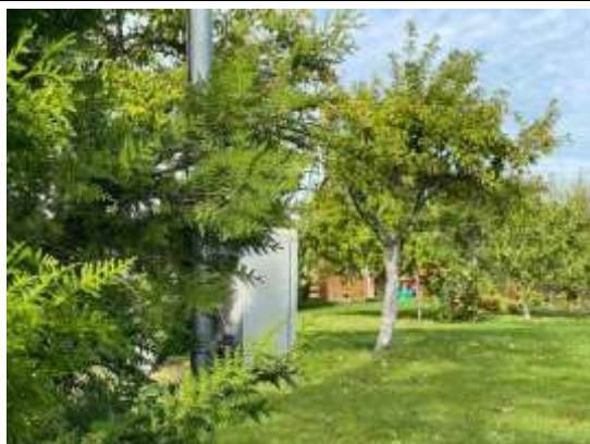
Elektrības sadales skapis
