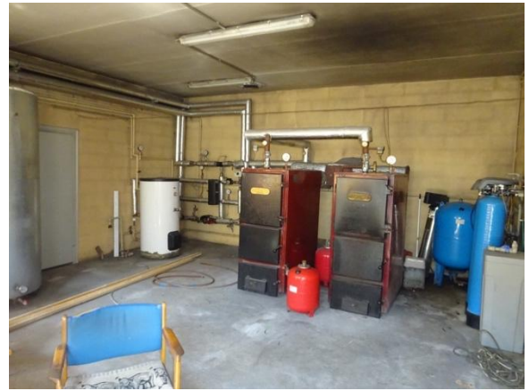
Apkures katla telpa
