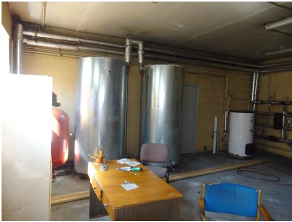
Apkures katla telpa
