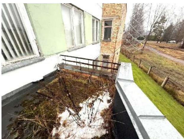
17. att. Ēkas ZA puses viestāvīgā apjoma jumts – uz jumta izteikts apaugums, segums bojāts, netiek nodrošināta nokrišņu novadīšana
