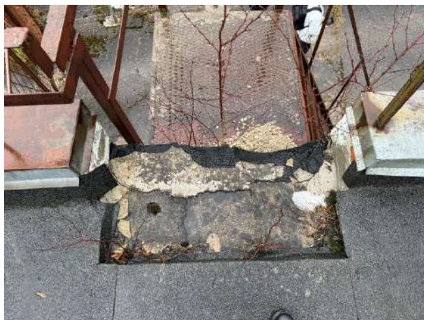
20. att. Ēkas ZA puses vienkārtīgā apjoma jumts – Zonā pie uzejas kāpnēm bojāts segums, redzami izdrupumi, izauguši koki
