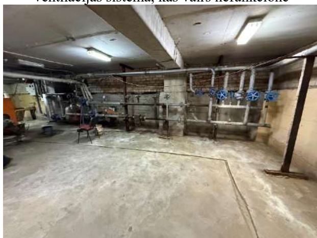
60. att. Apkures cauruļvadi katlu telpā
