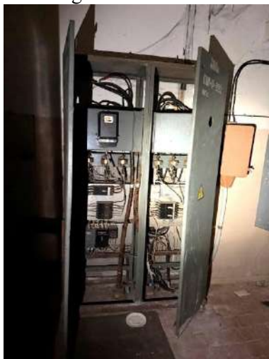
71. att. Eksploatācijā neesošas/atslēgtas elektroietaisies
