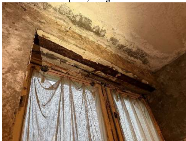
22. att. Zonā, kur ēkas ZA vienkārtīgajam apjomam bojāts jumts, nokrišņi iekļūst iekšējā telpā, redzami izteikti apdares bojājumi, mitruma piesātinājums konstrukcijās, t.sk. korodējusi pārsedze
