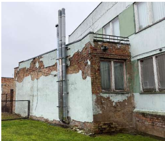
13. att. Ēkas ZA puses viestāvīgais apjoms. Fasādes apdare lielos laukumos bojāta/zudusi
