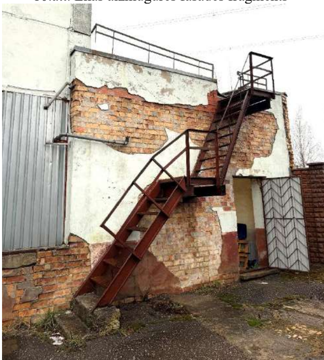
12. att. Ēkas ZA puses viestāvīgais apjoms ar ārējām metāla kāpnēm. Fasādes apdare lielos laukumos bojāta/zudusi
