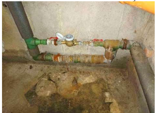
68. att. Ūdens uzskaites mezgls katlu telpā
