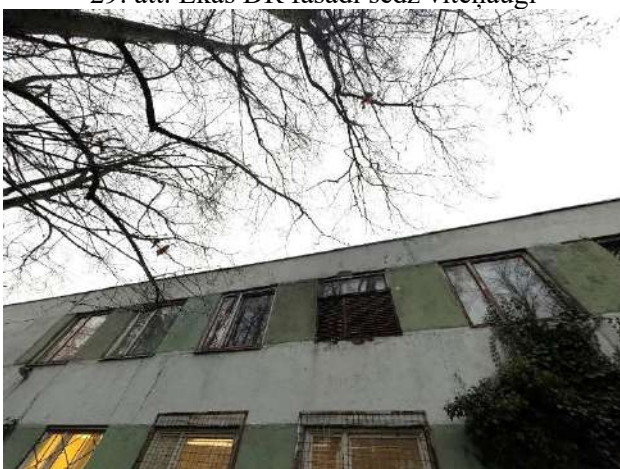
31. att. Ēkas DR fasādē koka zari aizskar parapetu, pārkarājas ēkas jumtam
