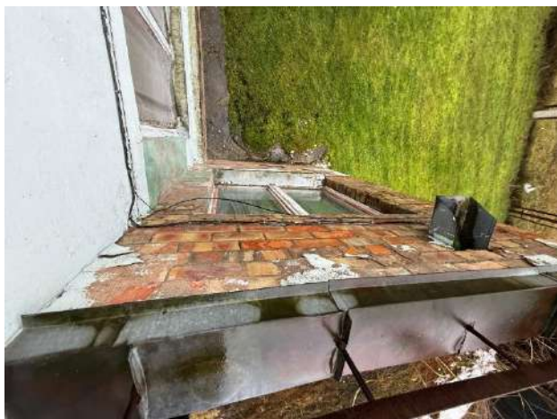
19. att. Ēkas ZA puses vienkārtīgā apjoma jumts – nokrišņu ūdens nonāk uz ēkas sienas
