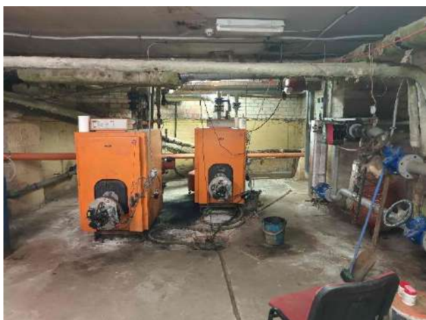
59. att. Šķidrā kurināmā katli ēkas pagrabā
