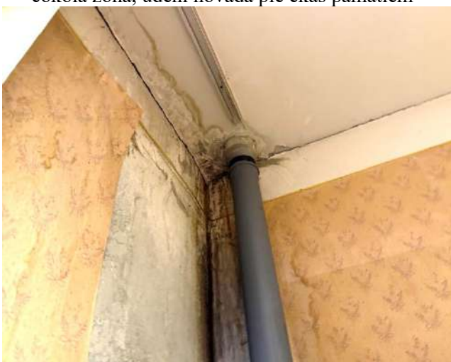
41. att. Lietus ūdens kanalizācijas caurule 2. stāva arhīva telpā – zonā ap to redzami notecējumi, apdares bojājumi
