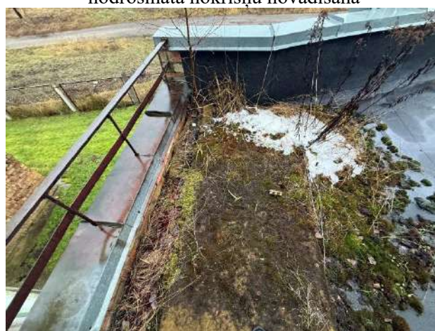
18. att. Ēkas ZA puses viestāvīgā apjoma jumts – uz jumta izteikts apaugums, segums bojāts, netiek nodrošināta nokrišņu novadīšana
