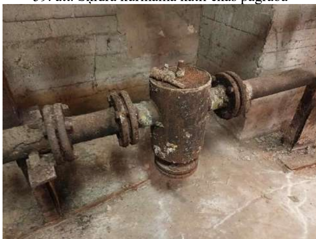
61. att. Korodējuši apkures cauruļvadi bez siltumizolācijas katlu telpā
