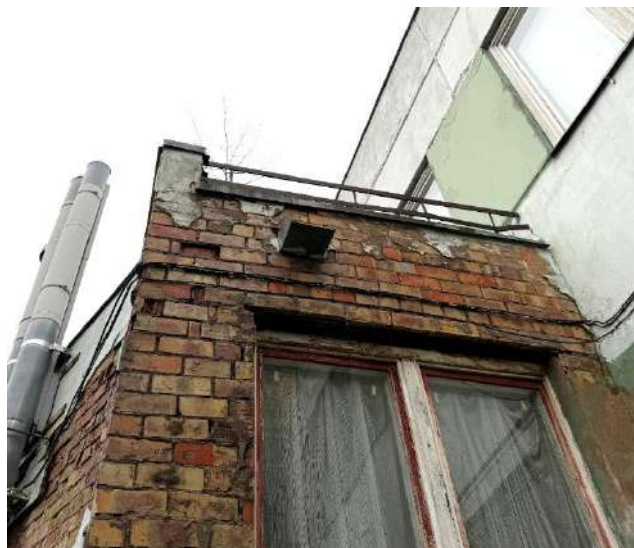
14. att. Ēkas ZA puses viestāvīgais apjoms. Fasādes apdare lielos laukumos bojāta/zudusi
