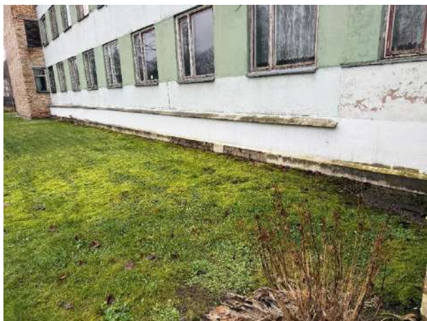
7.att. Mitruma radīti bojājumi ēkas cokola apdarē
