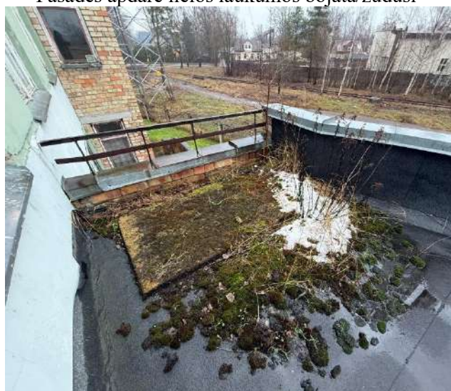
16. att. Ēkas ZA puses viestāvīgā apjoma jumts – uz jumta izteikts apaugums, segums bojāts, netiek nodrošināta nokrišņu novadīšana
