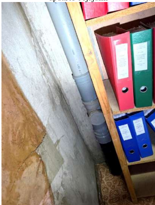
43. att. Lietus ūdens kanalizācijas caurule 2. stāva arhīva telpā – zonā ap to redzami notecējumi, savienojumu zonās notek ūdens
