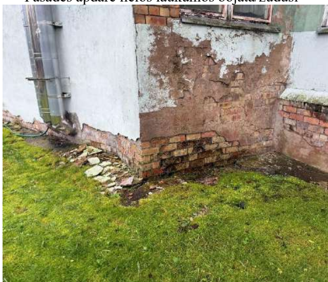
15. att. Ēkas ZA puses viestāvīgais apjoms. Fasādes apdare lielos laukumos bojāta/zudusi
