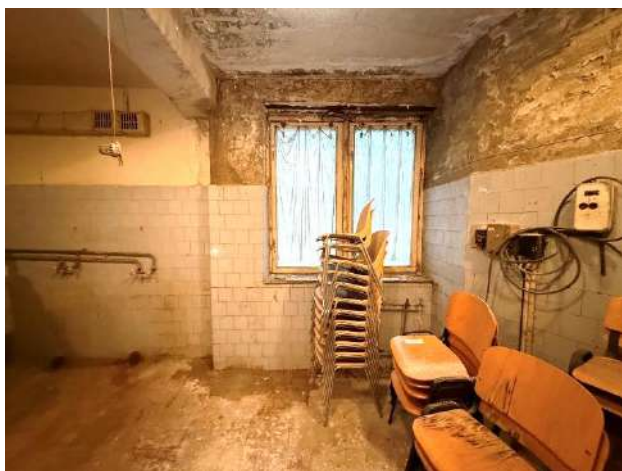
21. att. Zonā, kur ēkas ZA vienkārtīgajam apjomam bojāts jumts, nokrišņi iekļūst iekšējā telpā, redzami izteikti apdares bojājumi, mitruma piesātinājums konstrukcijās
