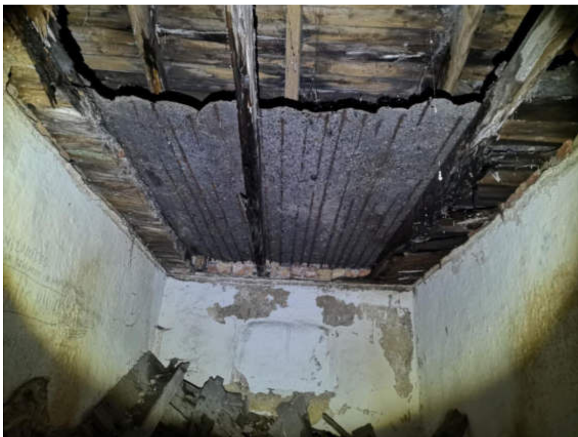
76.fotoattēls. Iebrucis pārsegums D1 korpusā.
