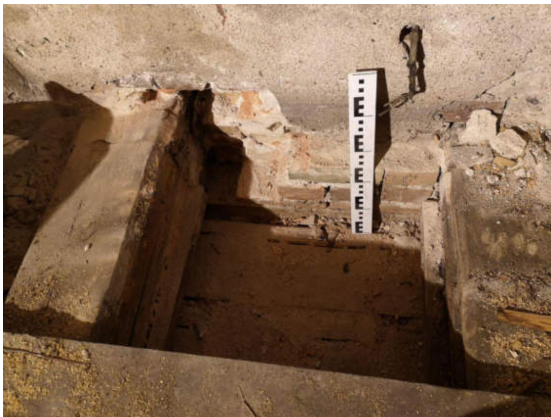
62.fotoattēls. 2.stāva pārseguma konstrukciju balstmezgla atsegums rīzalīta daļā. Hidroizolācija ap siju galiem un virs mūrbaļķa. Trupējies mūrbaļķis.
