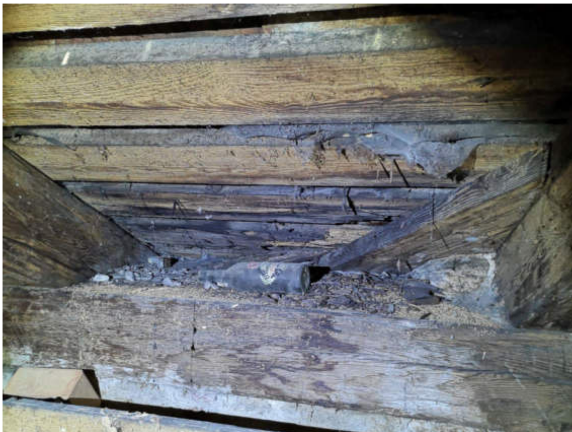
85.fotoattēls. Trupējušas jumta konstrukcijas spāru balstmezglā
