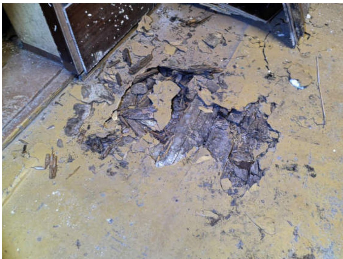
140.fotoattēls. Gīdas seguma un lāgu bojājumi 1.stāvā
