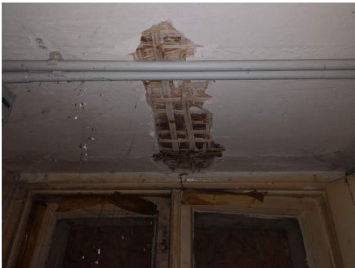
16.fotoattēls. Logailu pārsedzes atsegums [p5]
