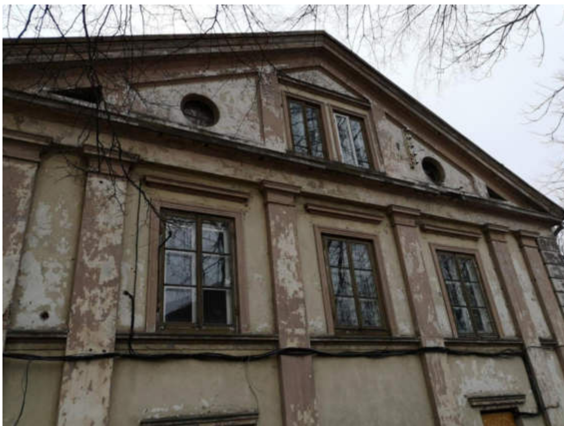
163.fotoattēls. A korpusa R fasādes bojājumi.
