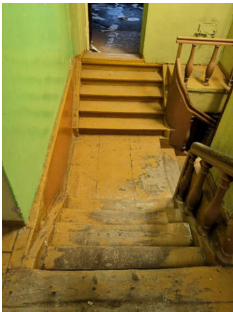
126.fotoattēls. Skats uz kāpņu K-1 laukumu un pagriezieniem. Pakāpienu bojājumi.
