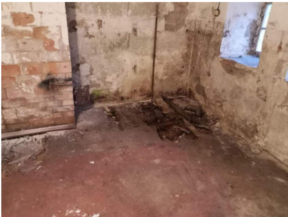
139.fotoattēls. Gīdas seguma un lāgu bojājumi 1.stāvā
