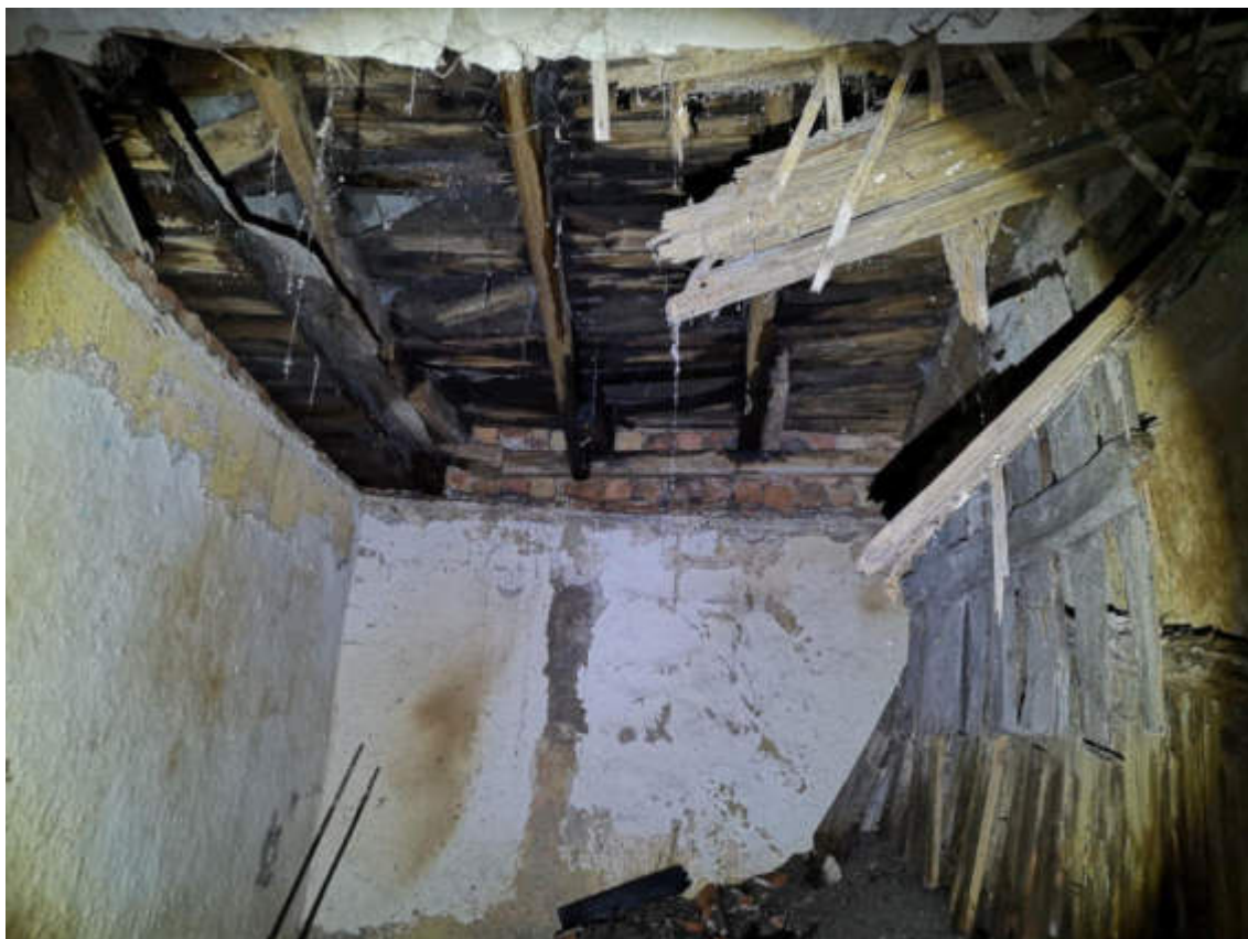
75.fotoattēls. Iebrucis pārsegums D1 korpusā.
