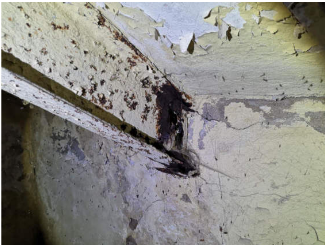
131.fotoattēls. Apjomīgi korodējusi kāpņu K-3 pasija.
