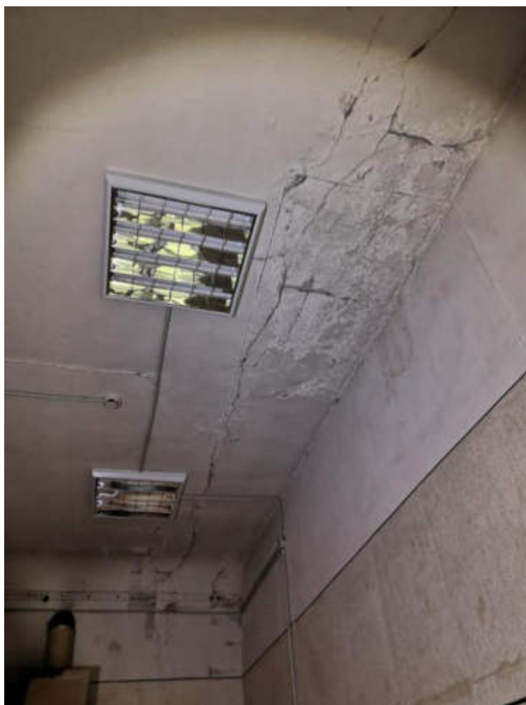
146.fotoattēls. Griestu apdares un domājams, pārseguma konstrukciju bojājumi 2.stāvā
