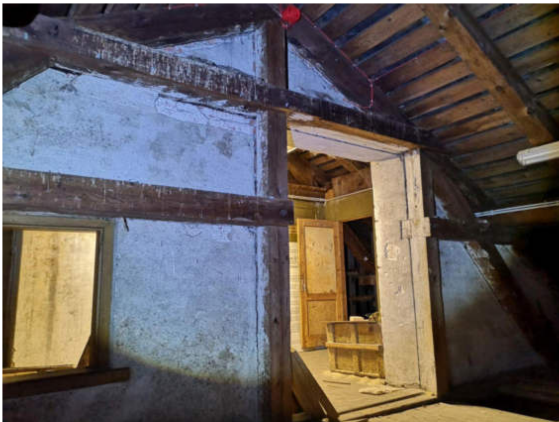
91.fotoattēls. Pārrauts A korpusa jumta augšējais saišķis vietā, kur ēkai pieslēdzas B korpuss.
