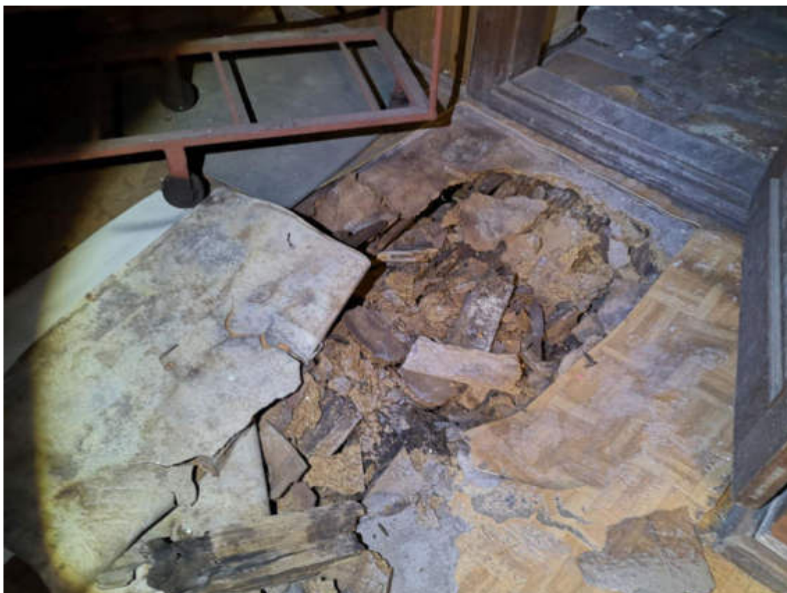
141.fotoattēls. Gīdas seguma un lāgu bojājumi 1.stāvā
