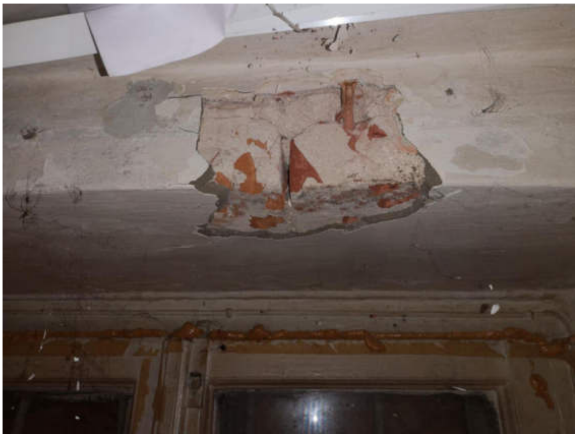
15.fotoattēls. Logailu pārsedzes atsegums [p6]
