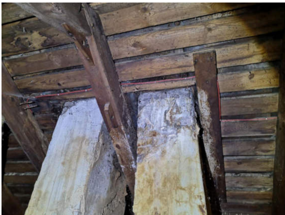
90.fotoattēls. Mitruma izraisīti dūmeņu apdares un mūrējuma bojājumi.
