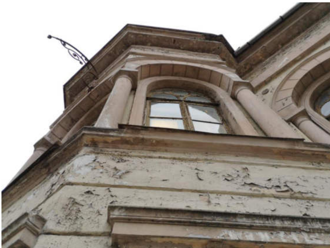
169.fotoattēls. Rizalīta fasādes apdares bojājumi
