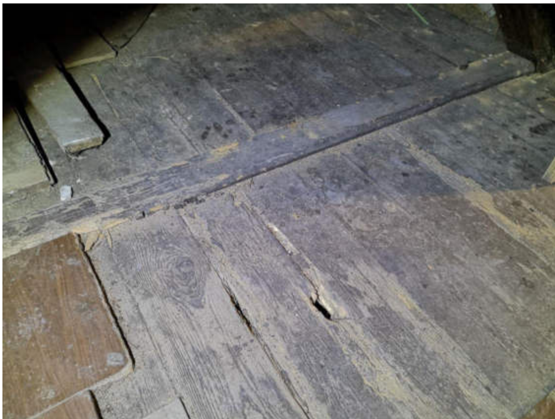
129.fotoattēls. Grīdas dēļu bojājumi bēniņos.
