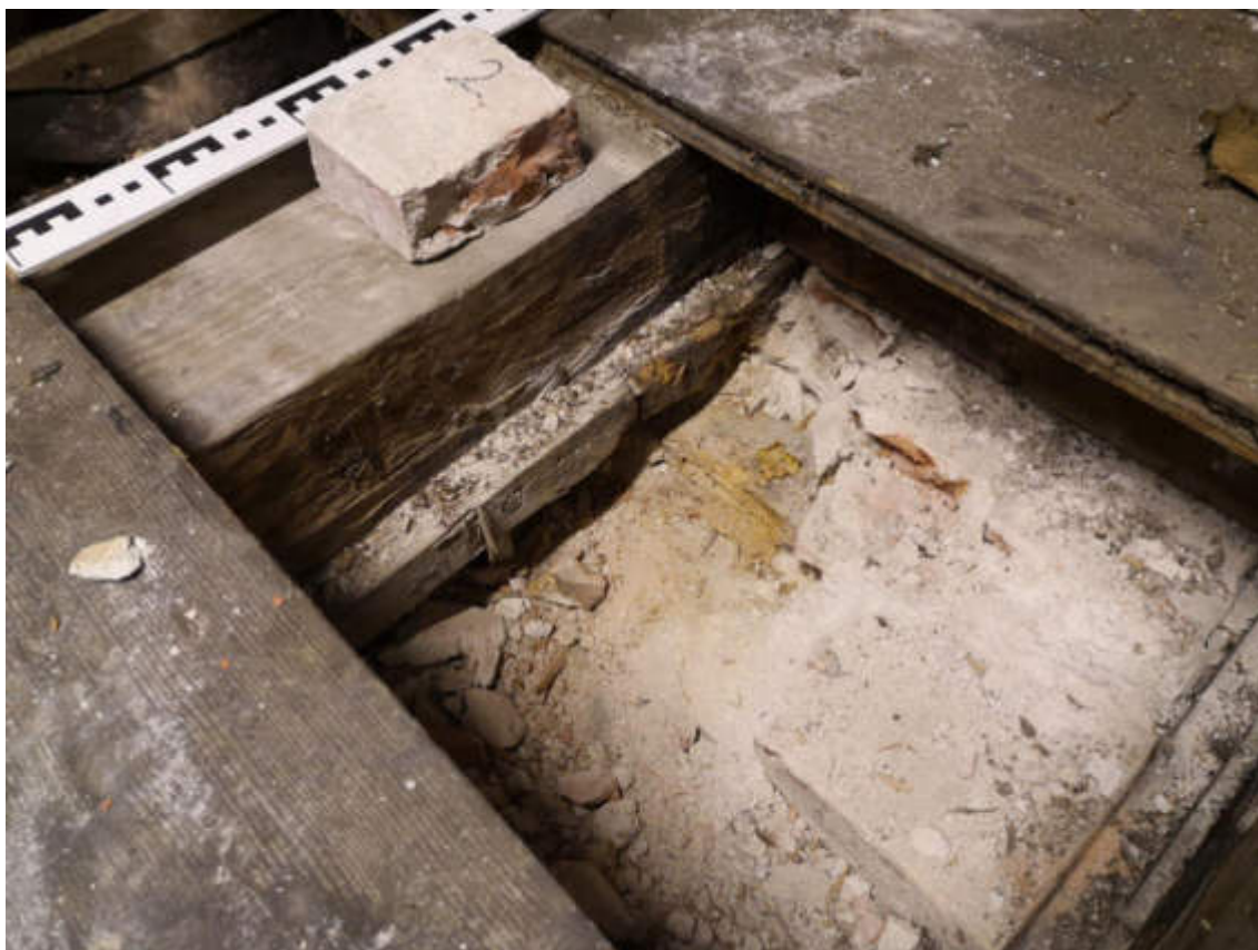
51.otoattēls. Trupējis mūrbaļķis zem pārseguma sijām
