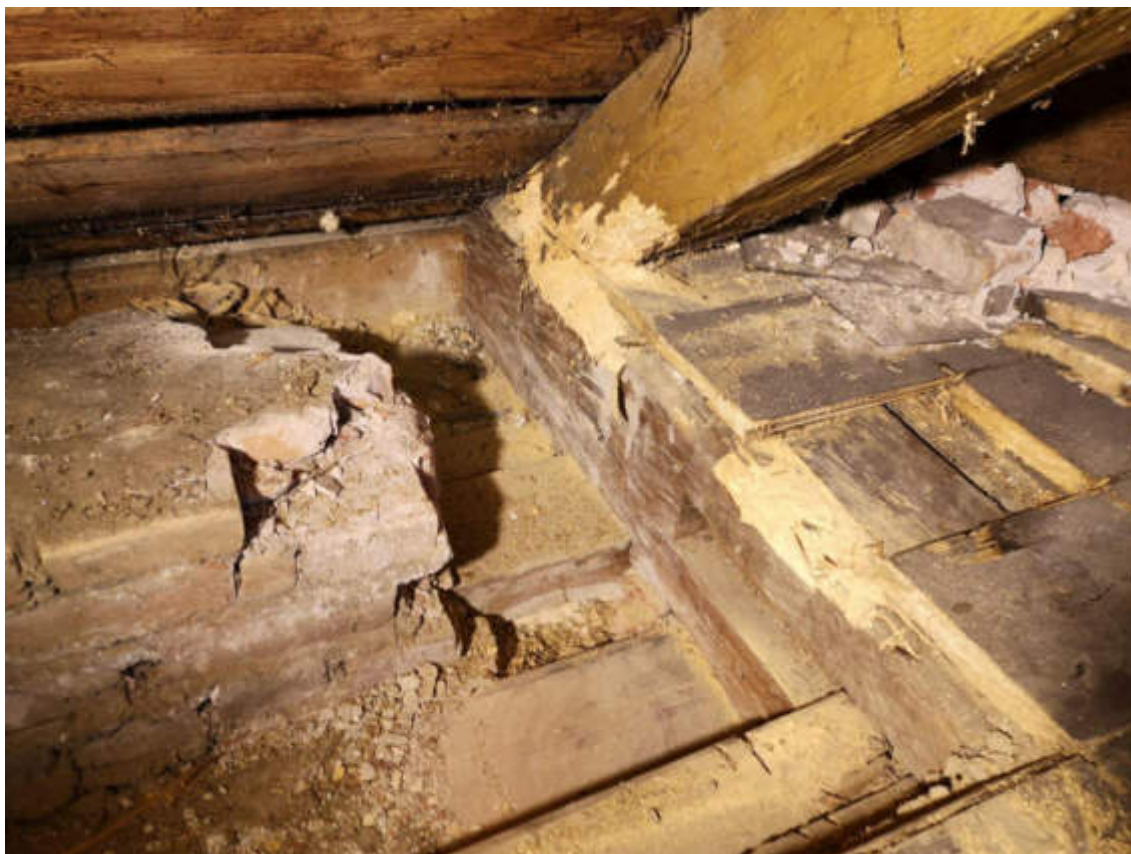
55.fotoattēls. 2.stāva pārseguma balstmezgla atsegums. Trupējušas pārseguma un jumta nesošās konstrukcijas
