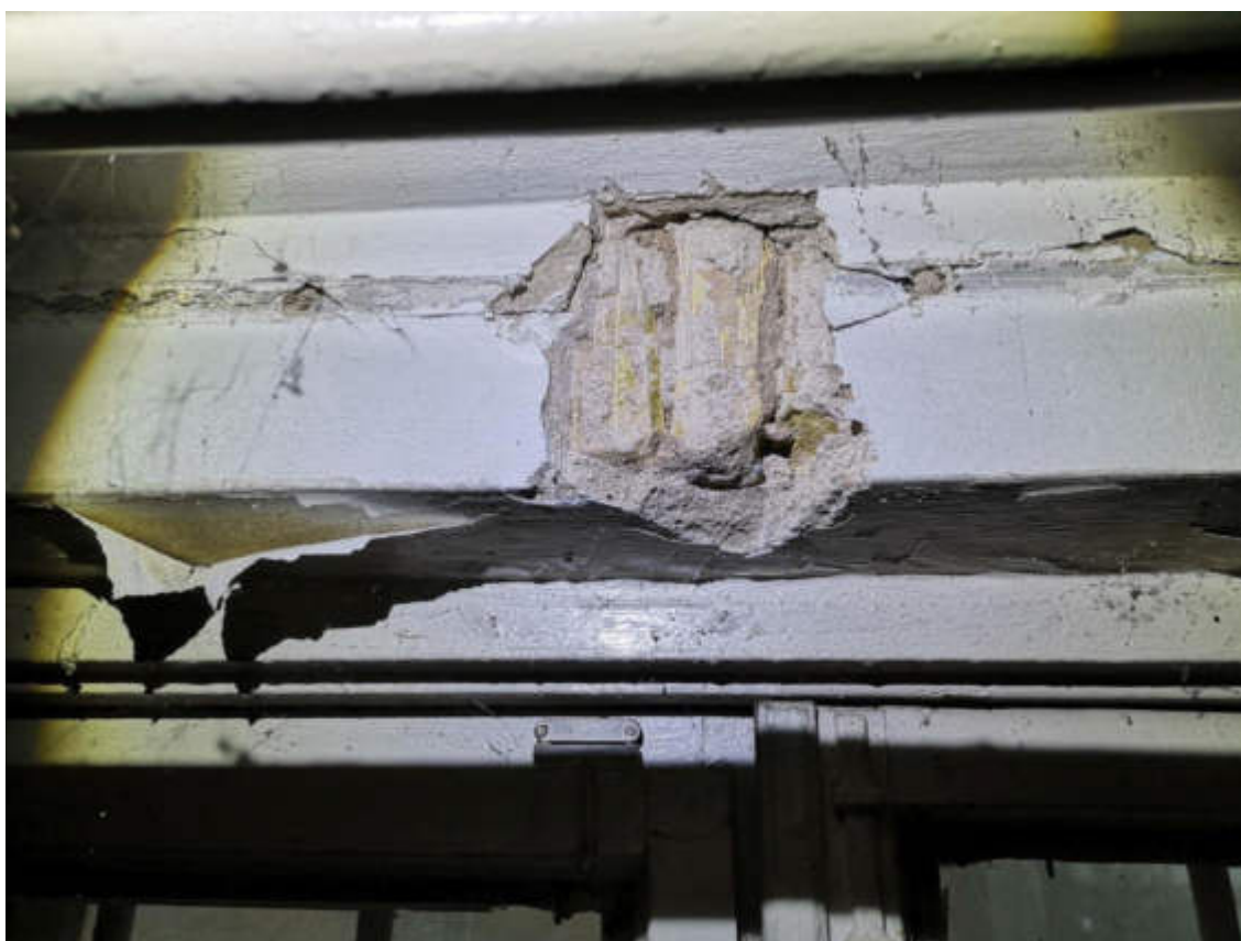
24.fotoattēls. Logailu pārsedzes atsegums [p4]
