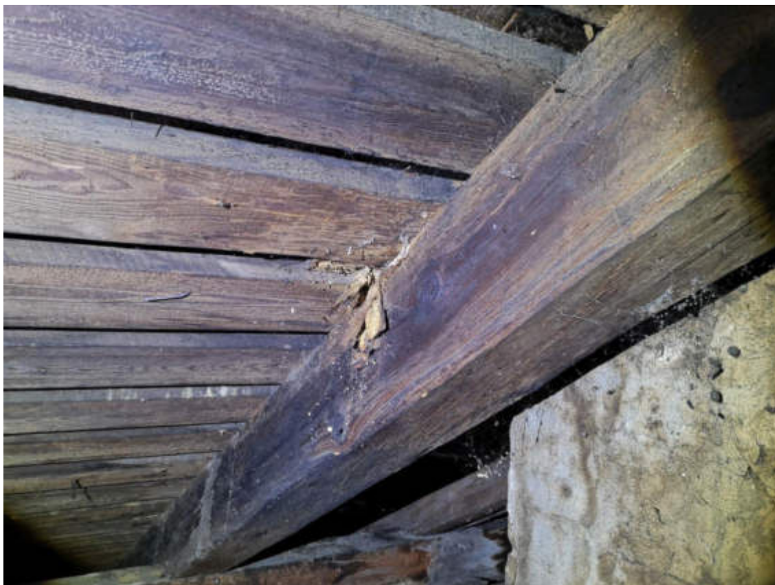
99.fotoattēls. Trupējusi spare un jumta seguma dēļu klājs.
