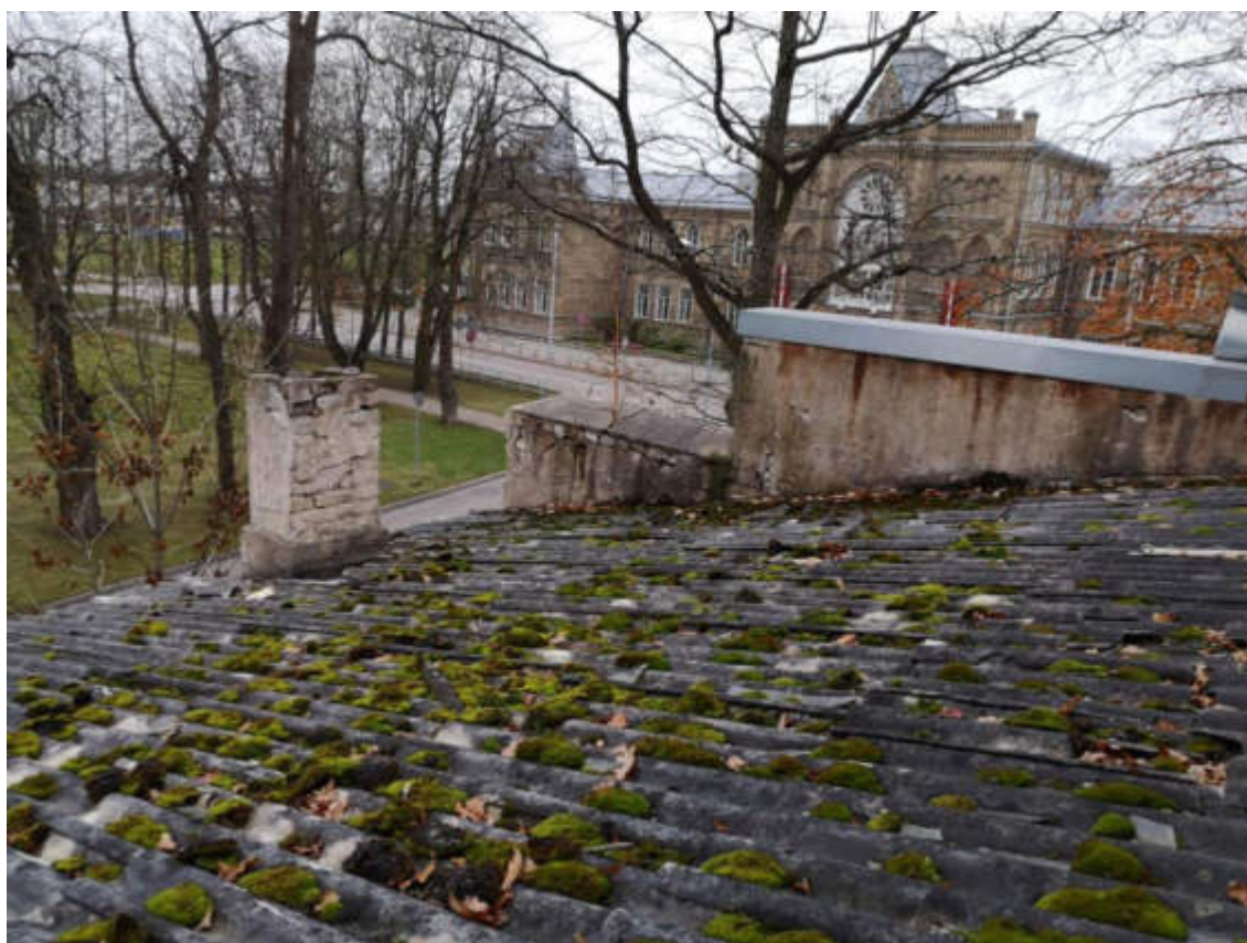
116.fotoattēls. Bīstami saplaisājis B1 korpusa parapeta konstrukcijas fragments pret Ventspils ielu
