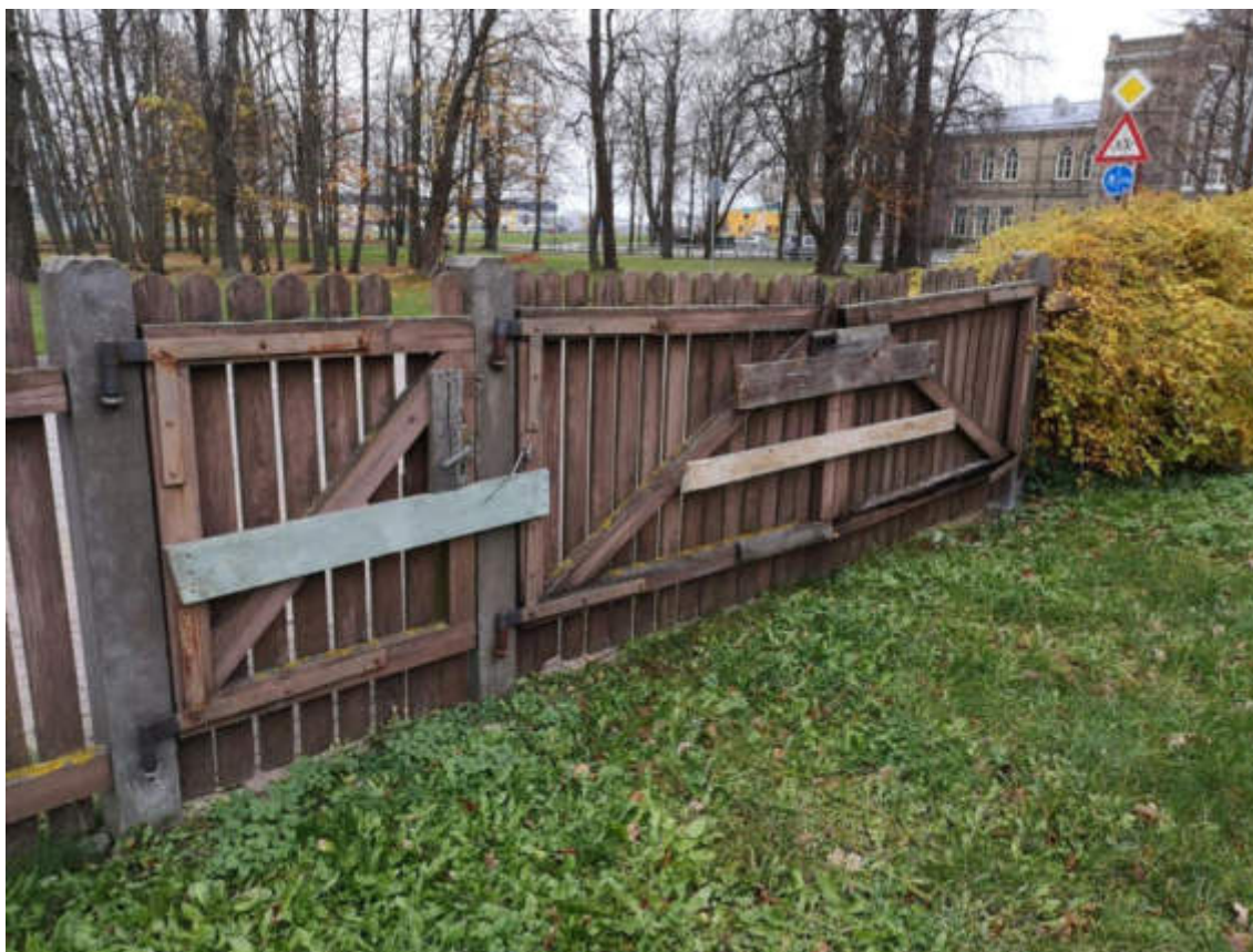
3.fotoattēls. Deformējušies vārti, trupējuši vārtu elementi.
