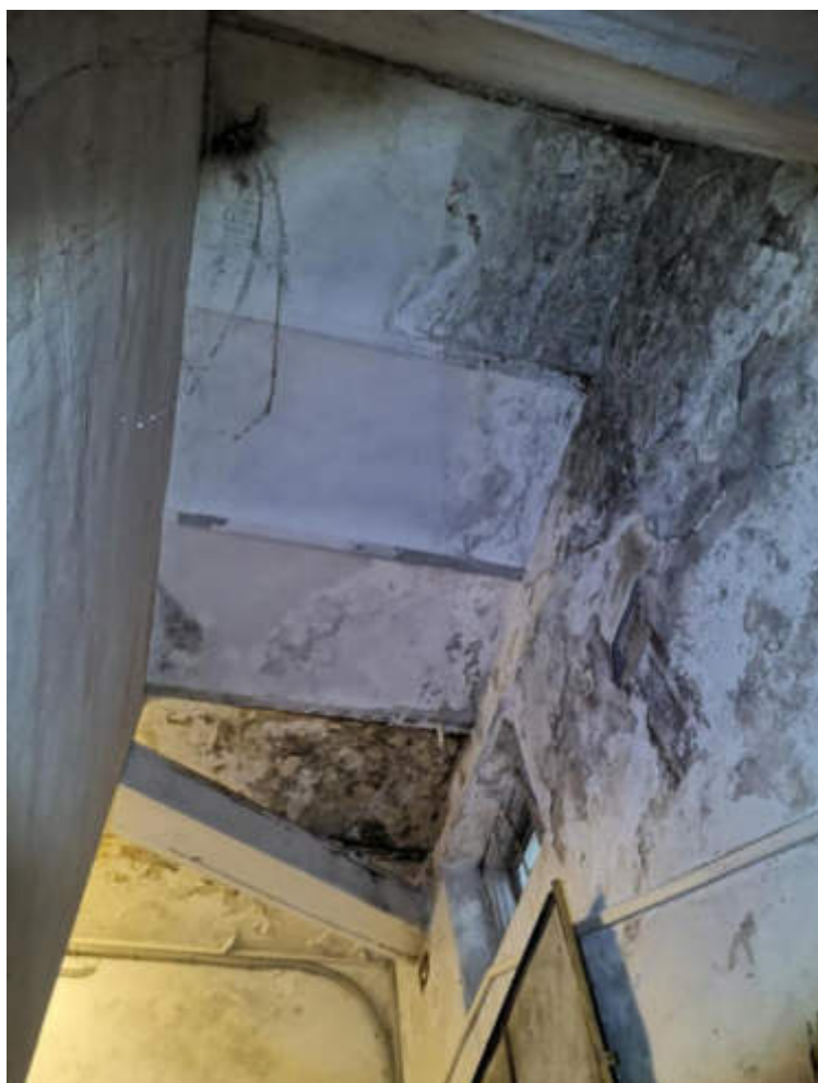
66.fotoattēls. Erodējušas un korodējušas 2.stāva pārseguma konstrukcijas.
