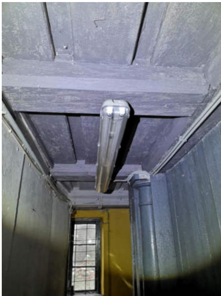
26.fotoattēls. Kāpņu telpas K-2 pārseguma siju izmija
