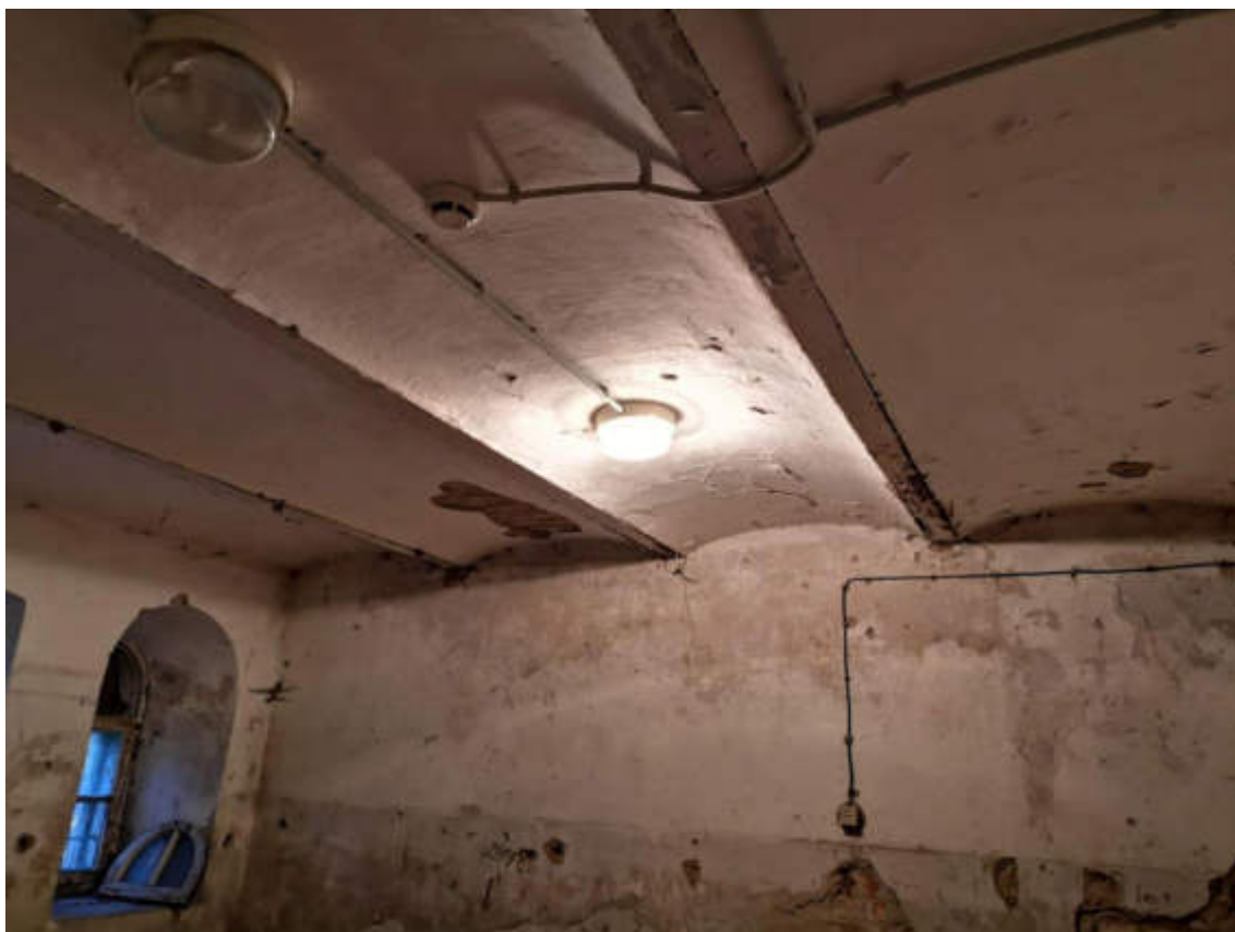
63.fotoattēls. Prūšu velvju 1.stāva pārsegums. Metāla siju apakšējā plaukta bojājumi.
