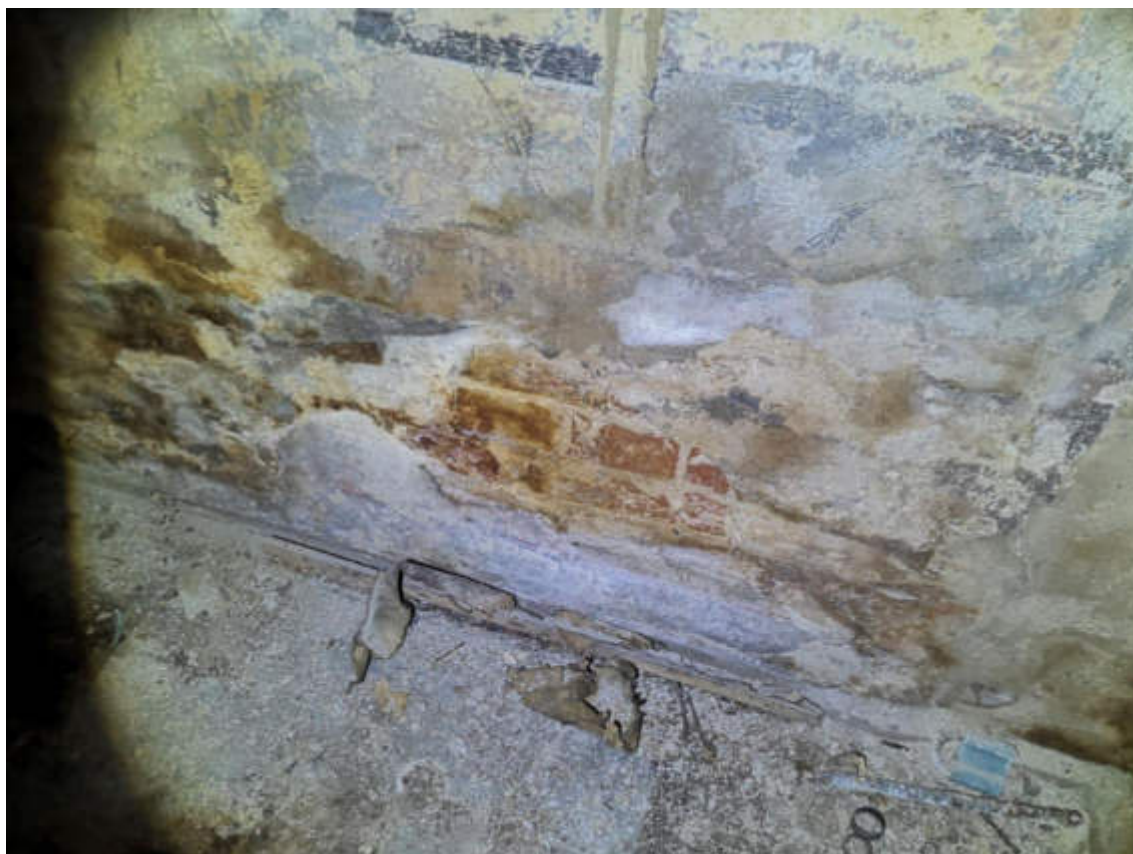
138.fotoattēls. Mūra ārsienas izsāļojumi un erozija
