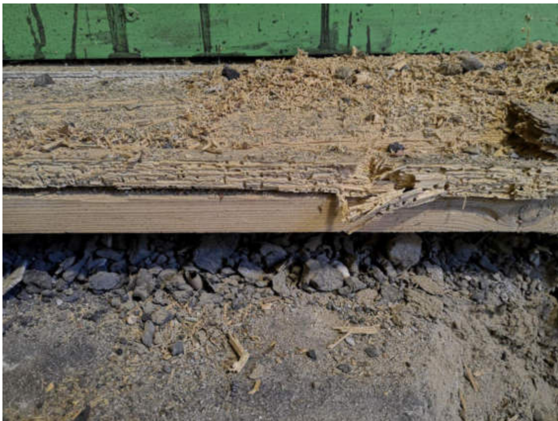
135.fotoattēls. Kokgraužu radīti grīdas dēļu bojājumi 2.stāvā.
