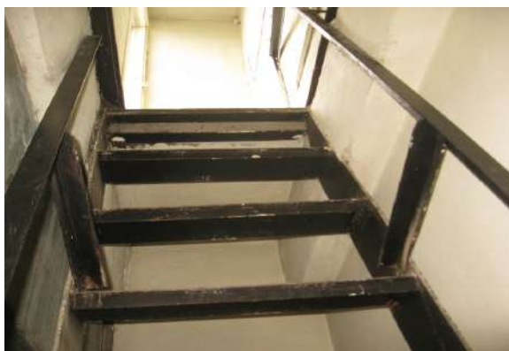
F-12. Vienlaidu stāvas metāla kāpnes, kas ved no 6.stāva uz jumtu un lifta mašīntelpu. Nolietojies krāsojums, kāpjot jūtama kustība.
