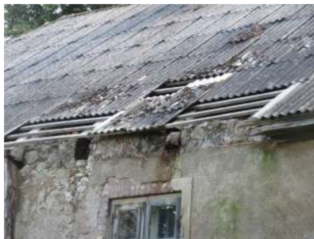
jumta seguma bojājumi
