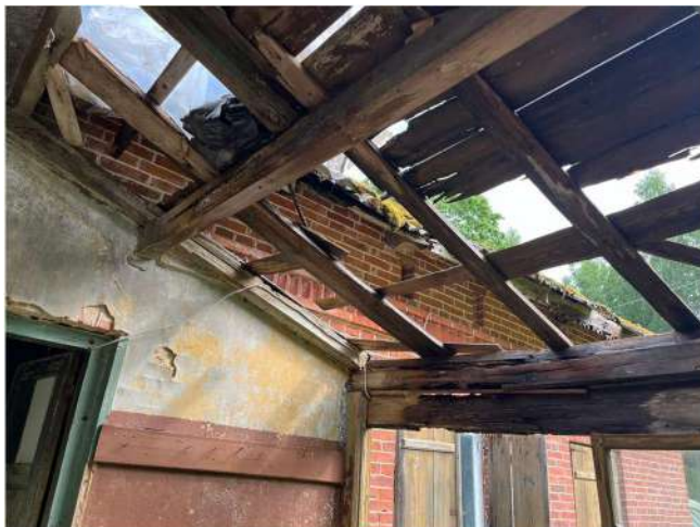
Verandas jumta bojājums
