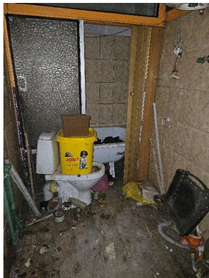
Sanitār tehniskā telpa
