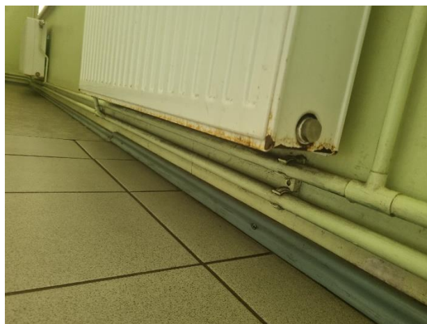
5.5.2. att. Apkures sistēmas tērauda konvektora apakšējā daļā radušies korozijas bojājumi
