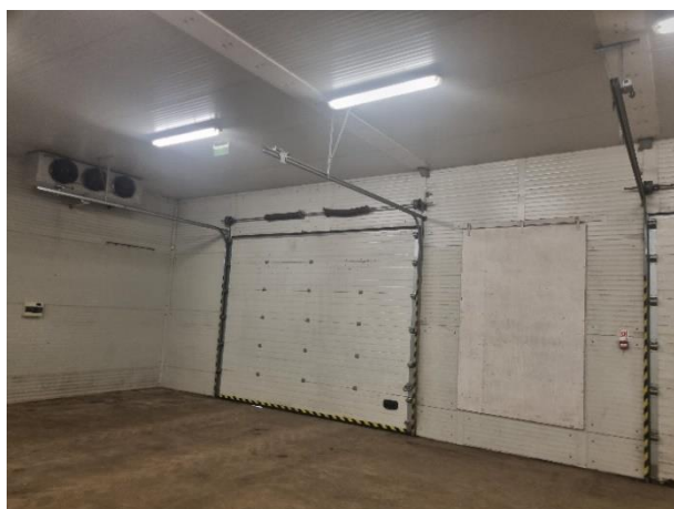
4.2.1. att. Skats uz ēkas ārsienām noliktavas daļā
