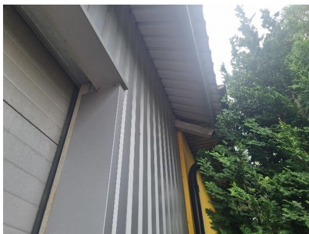
4.2.4. att. Skats uz ēkas ārsienām noliktavas daļā
