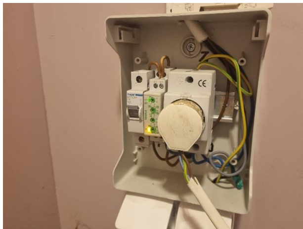
5.9.3. att. Kabeļu dzīslas kontaktdakšā bez aizsardzības
