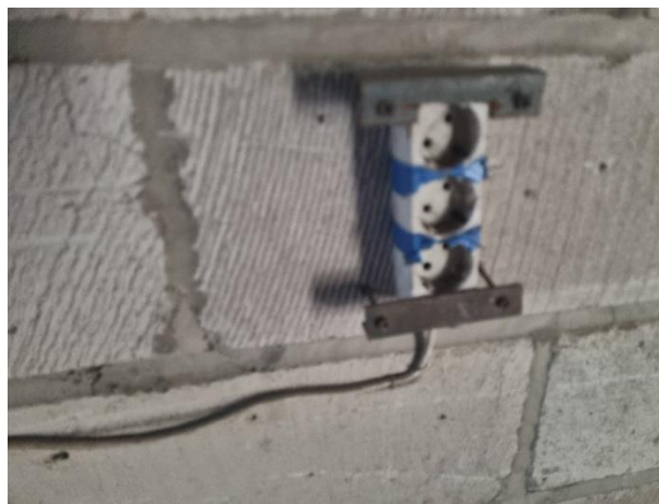
5.9.2. att. Elektroinstalācija neatbilst drošas ekspluatācijas nosacījumiem
