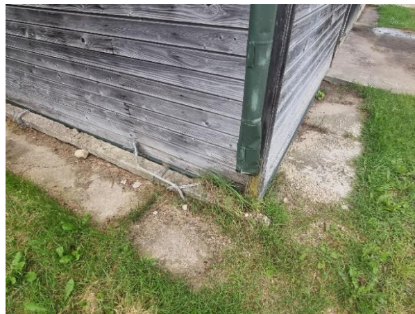
4.8.6. att. Bojāta lietusūdens noteka
