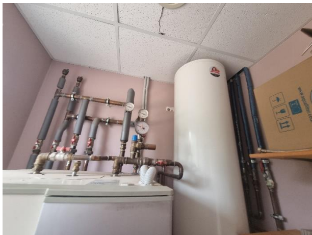
5.2.1. att. Karstā ūdens sagatavošanai uzstādīts ūdens sildītājs
