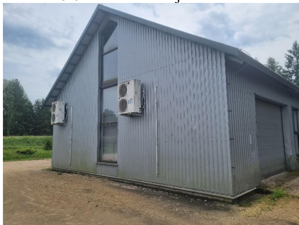
5.6.3 att. Kondicionieru ārējie bloki
