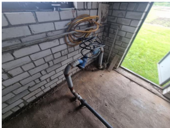
5.1.1. att. Ūdensvada caurule
