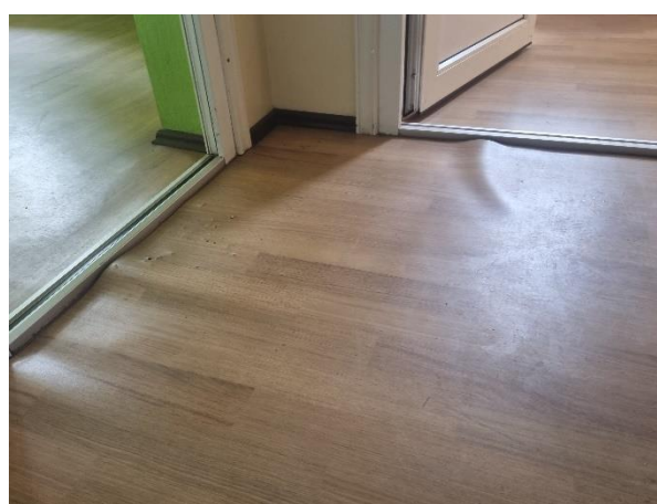
4.12.2. att. No pamatnes atlīmējies linoleja grīdas segums gaitenī
