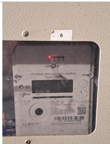
6. dzīvokļa elektrības skaitītājs
