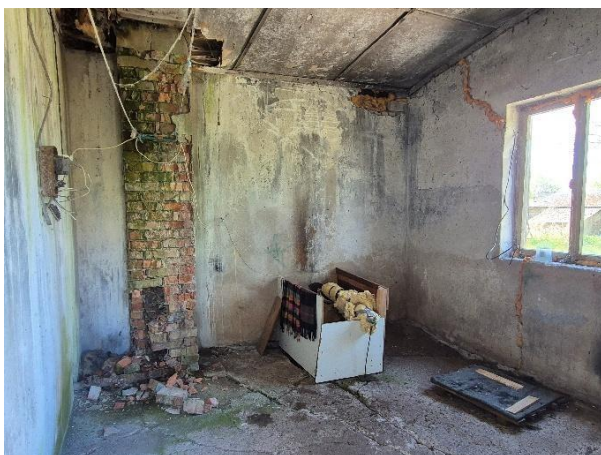
Ūdens ņemšanas vieta ēkas 1.stāvā
