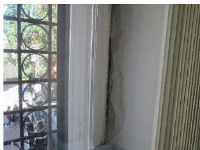
49.att. Bojāta apdare lokālās ailu plaknēs.
