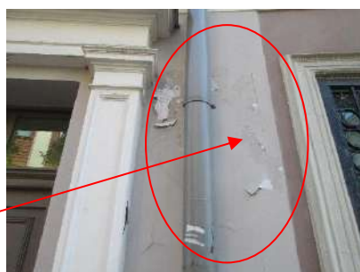
52.att. Apdares bojājumi dzegas mezglā.
