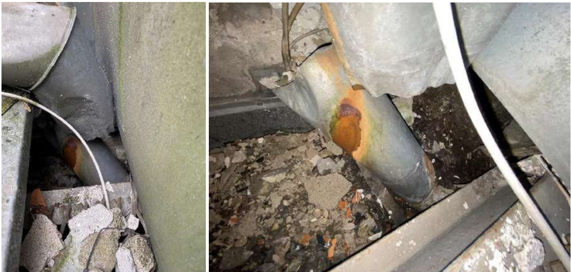
12. un 13. att. Atdalījis lietus ūdens notekcaurules fragments, kā rezultātā no jumta netiek novadīts nokrišņu ūdens, tas nonāk uz kāpņu telpas sienas
