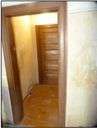
Tualete kāpņu telpā
