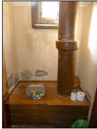
Tualete kāpņu telpā
