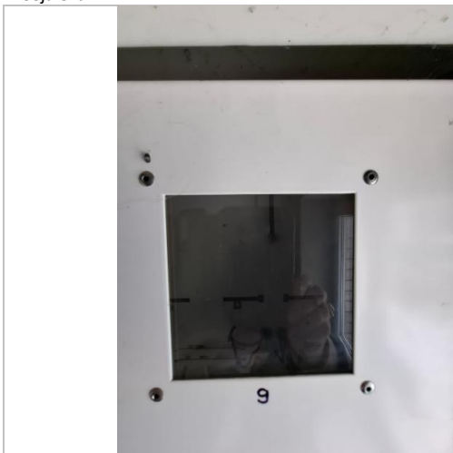
Dzīvokļa elektrības skaitītājs (demonētts)
