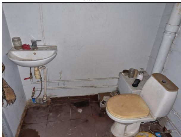
Savienotā sanitārtehniskā telpa
