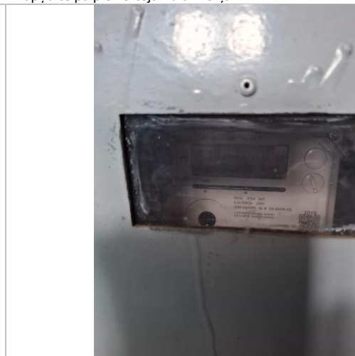
Dzīvokļa elektrības skaitītājs
