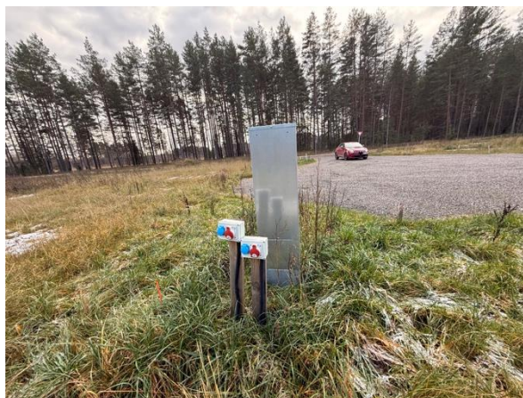
Elektrības sadales skapis
