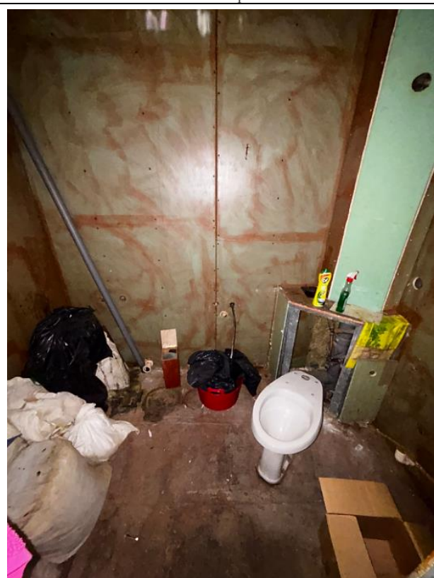
Savienotā sanitārtehniskā telpa
