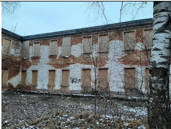
2.2.9. att. Mūra erozija
