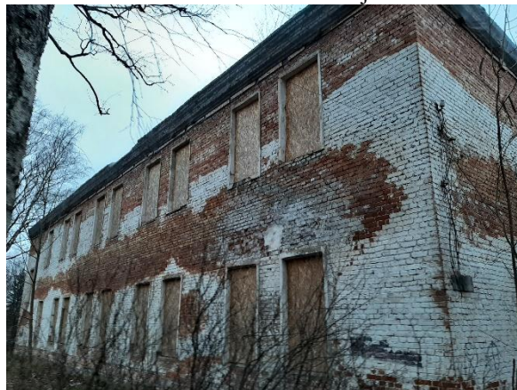
2.2.20. att. Mūra erozija
