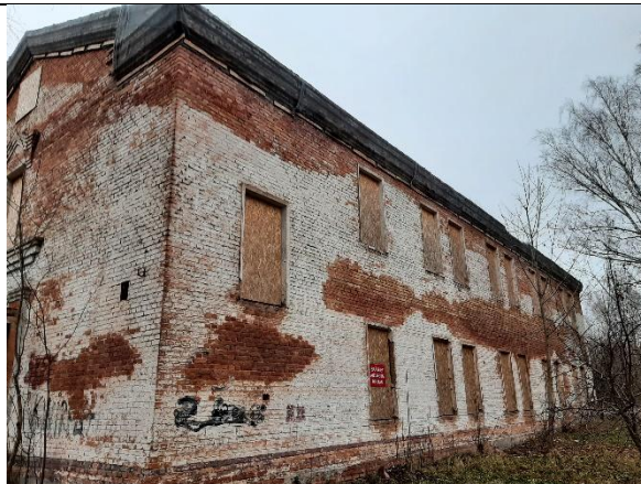
2.2.2. att. Mūra erozija
