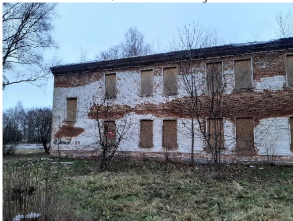
2.2.21. att. Mūra erozija
