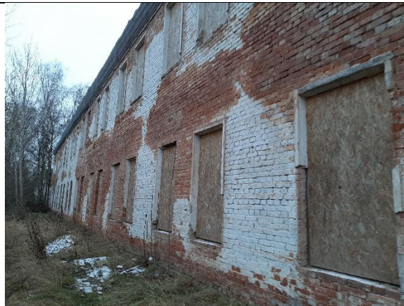
2.2.18. att. Mūra erozija
