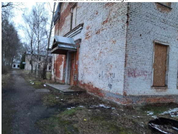
2.2.11. att. Mūra erozija
