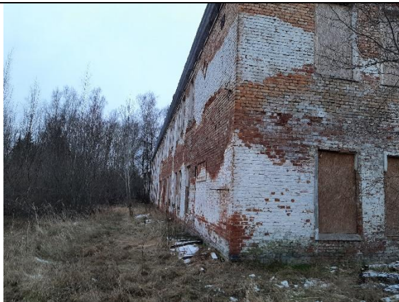
2.2.17. att. Mūra erozija
