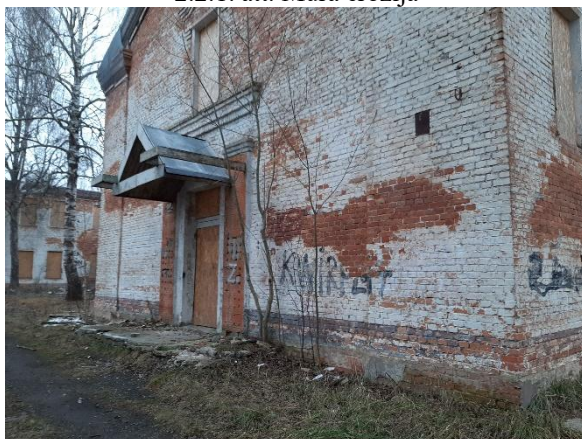
2.2.3. att. Mūra erozija
