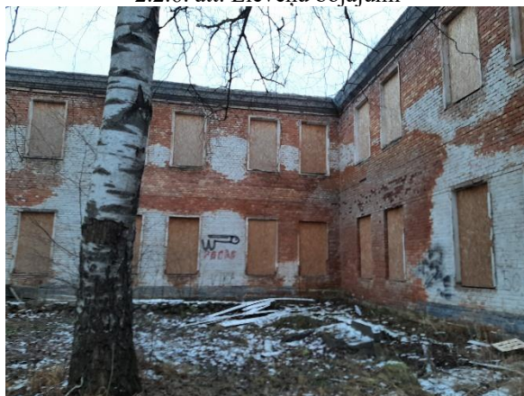
2.2.8. att. Mūra erozija
