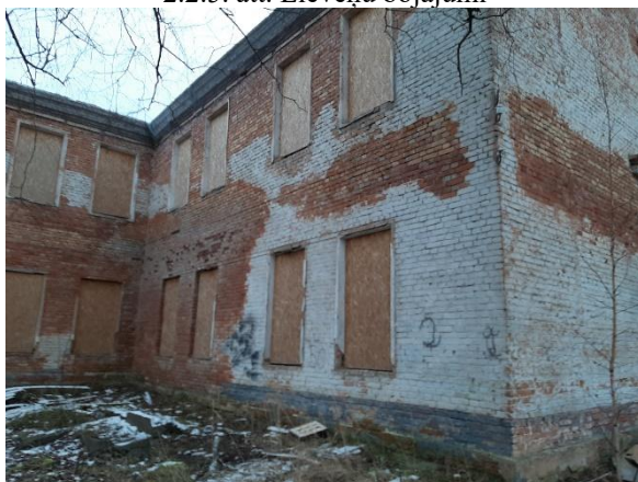
2.2.7. att. Mūra erozija
