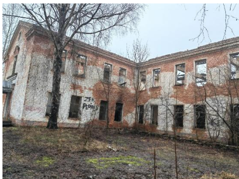
2.5.1. att. Iegruvušas jumta nesošās konstrukcijas (foto no 18.01.2023.)
