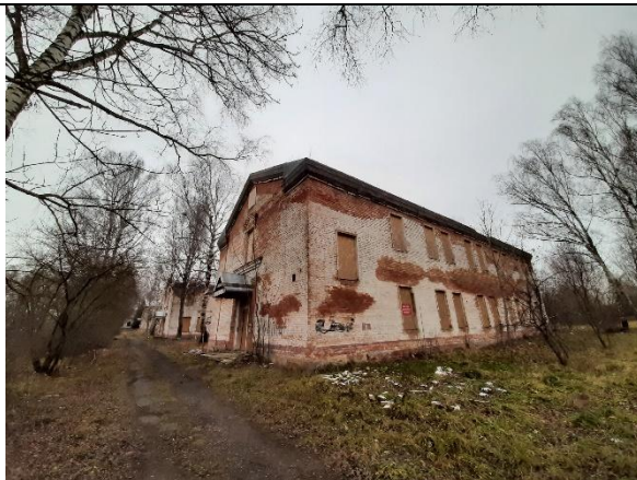
2.2.1. att. Mūra erozija
