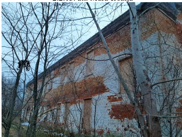
2.2.15. att. Mūra erozija
