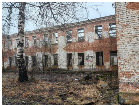
2.5.2. att. Iegruvušas jumta nesošās konstrukcijas (foto no 18.01.2023.)
