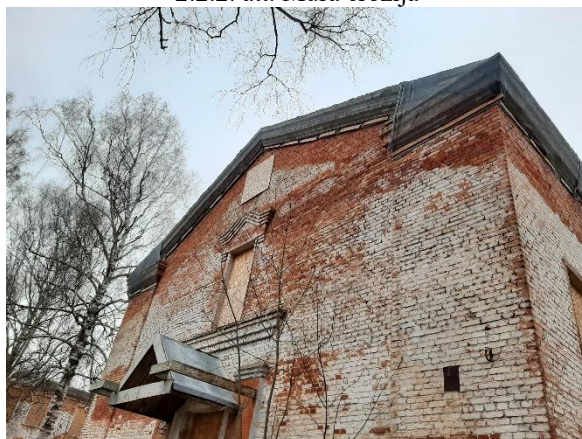
2.2.4. att. Mūra erozija
