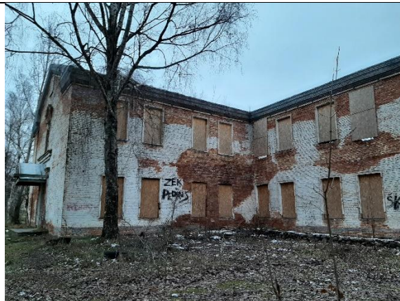
2.2.10. att. Mūra erozija
