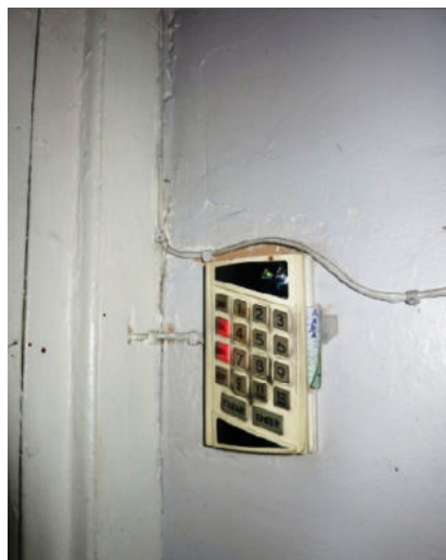
Apsardzes iekārta 1.stāvā.
