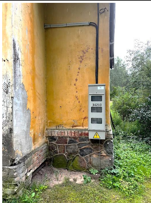
Dzīvojamās ēkas fasāde, skats uz elektrības sadali
