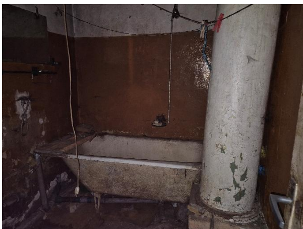
Sanitārtehniskā telpa (telpa Nr.2)
