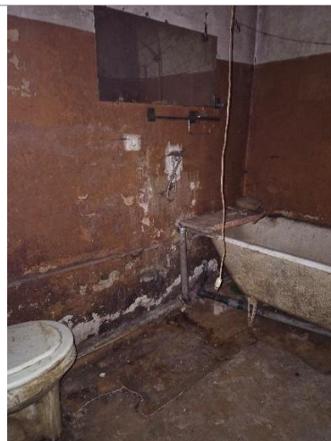
Sanitārtehniskā telpa (telpa Nr.2)
