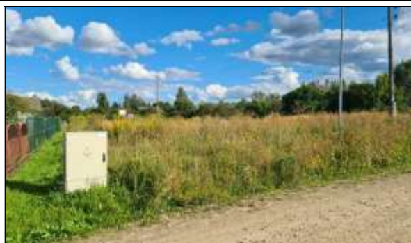
Elektrības pieslēguma vieta
