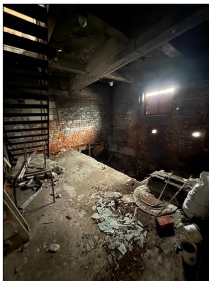
1.stāvs. Sūkņu telpa, telpa nr.9
