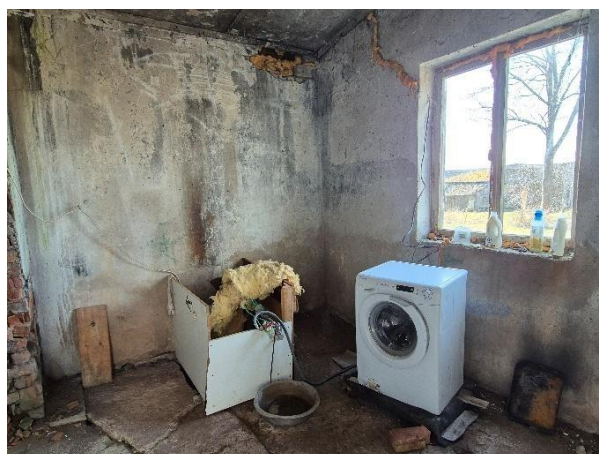
Ūdens ņemšanas vieta ēkas 1.stāvā
