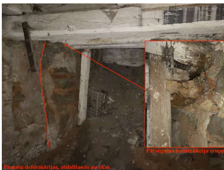
4.25.att. Pagraba nesošo pārseguma siju konstrukciju deformācijas, trupe
