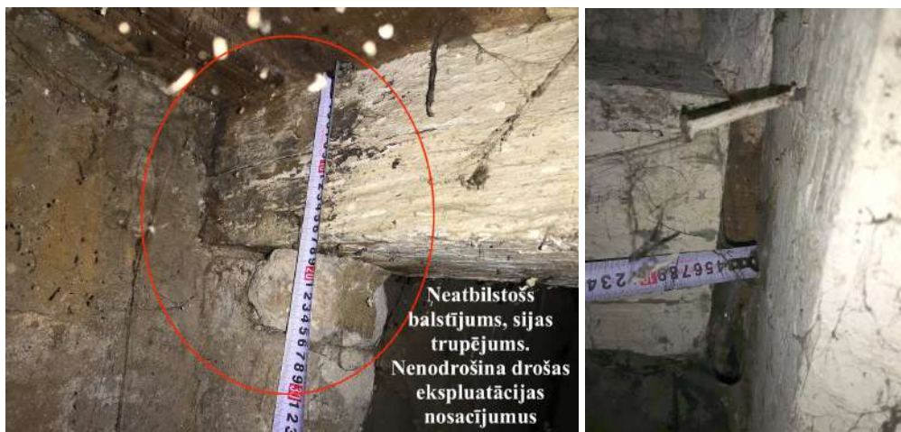
4.23. un 4.24.att. Pagraba nesošo pārseguma siju konstrukciju deformācijas
