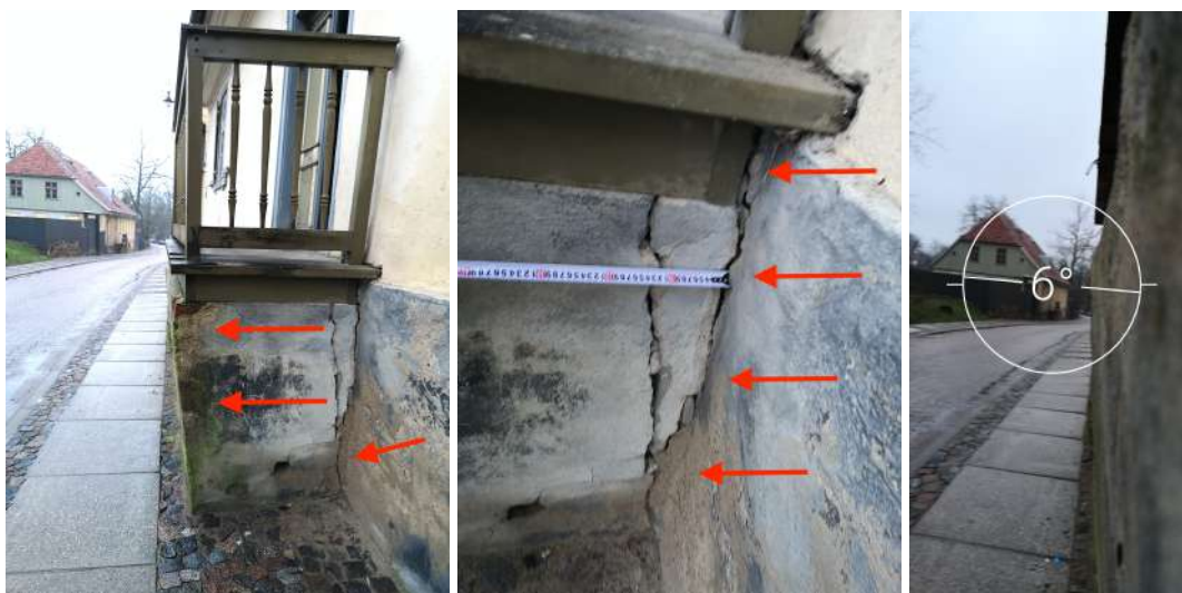
4.29., 4.30. un 4.31.att. Kāpņu deformācijas, atdalīšanās no ēkas konstrukcijām
