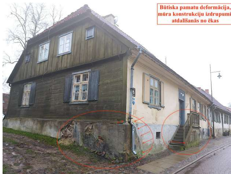
4.8.att. Ēkas ZR puse. Būtiski deformējas pamati, atdalās no ēkas pamatkonstrukcijas. Tāpat arī deformējas ieejas kāpņu mezgls R pusē. Šīs deformācijas ir progresējošas. Neatbilst drošas ekspluatācijas nosacījumiem, rada bīstamību.
