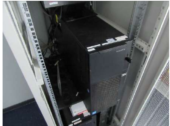
BMS vadības sistēmas aprīkojums - Sistēmbloks
