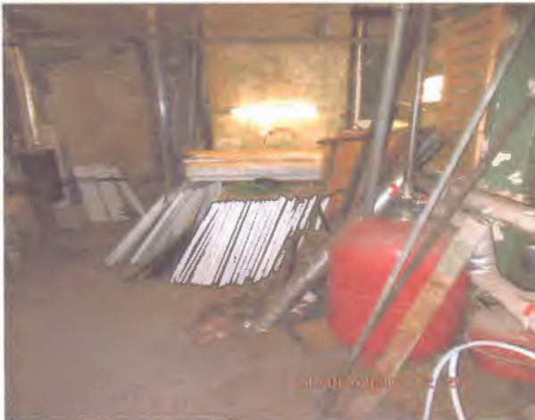
Fotofiksācija Nr.7 - siltummezglā tiek uzglabāti degtspējīgi materiāli
