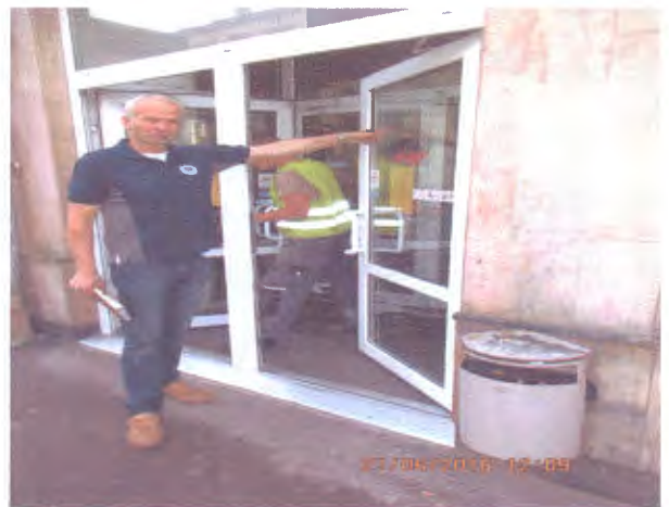
Fotofiksācija Nr.6 - 1.stāva ārējās evakuācijas durvis veras pretēji evakuācijas ceļa virzienam
