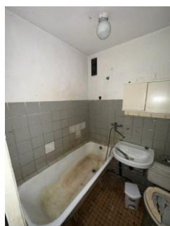
Savienotā sanitārtehniskā telpa
