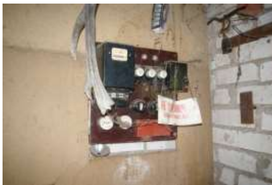
Būve (garāžas ēka) ar kadastra apzīmējumu 1700 002 0135 008, garāža Nr.268, elektroenerģijas sadales punkts
